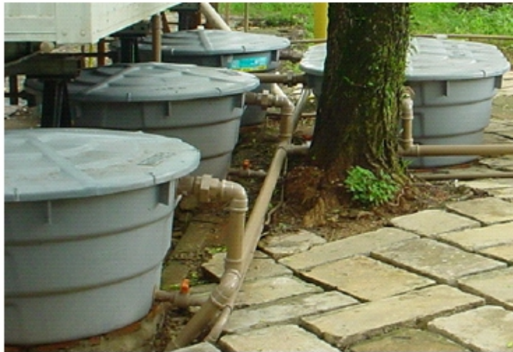
Figura 10: Sistema de armazenamento de água cinza coletada
