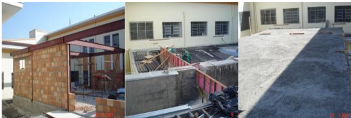
Ilustração 10 - Casa de Máquinas – 1) Execução da alvenaria. 2) Execução das formas das vigas. 3) Conclusão do capeamento da laje pré-moldada.
