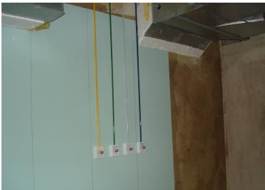
Ilustração 7 – Parede parcialmente revestida com laminado melamínico. Revestimento amplamente utilizado pela arquiteta devido à facilidade de assepsia, mas cuja instalação é complicada devido ao forte odor do adesivo utilizado.
