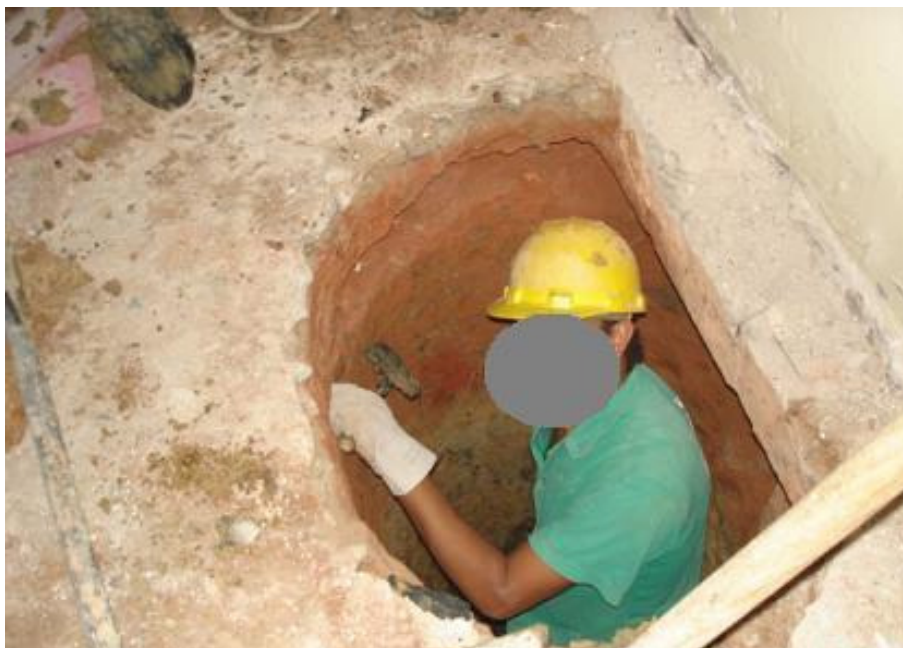
Ilustração 5 – Escavação de tubulão na sala de tomografia para reforço estrutural necessário para a supressão do pilar.
