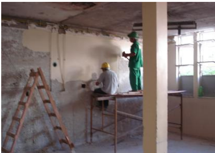
Ilustração 4 – Parede cujo revestimento teve que ser demolido por estar em mau estado. Não estava previsto inicialmente.
