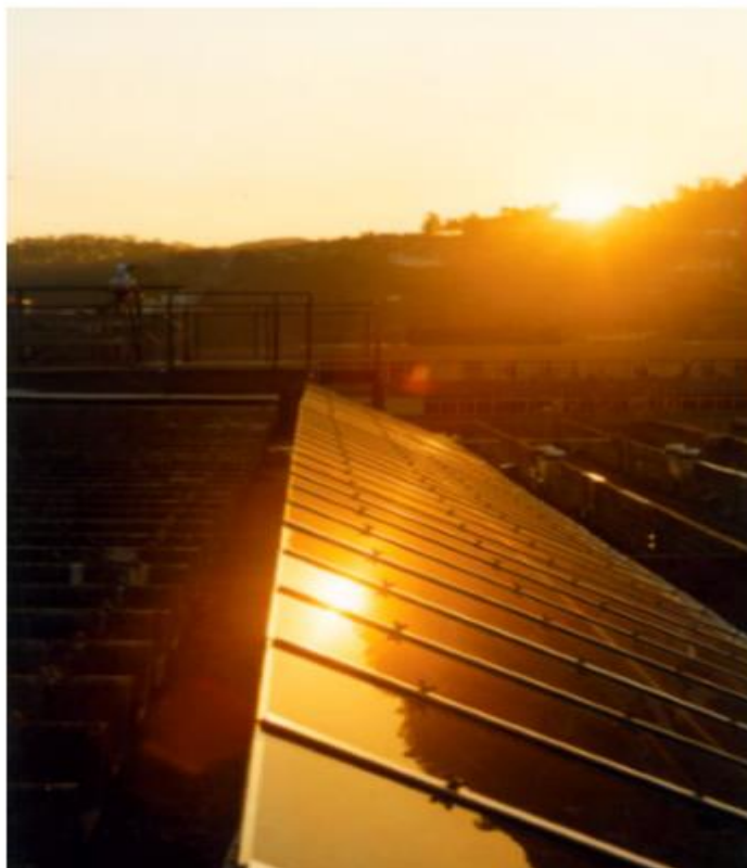
Figura 8 – Vista ao por do sol do sistema instalado junto ao LABSOLAR/UFSC. A instalação solar fotovoltaica recebe a luz solar sem sombreamento por obstáculos desde as primeiras horas da manhã até o final da tarde.
