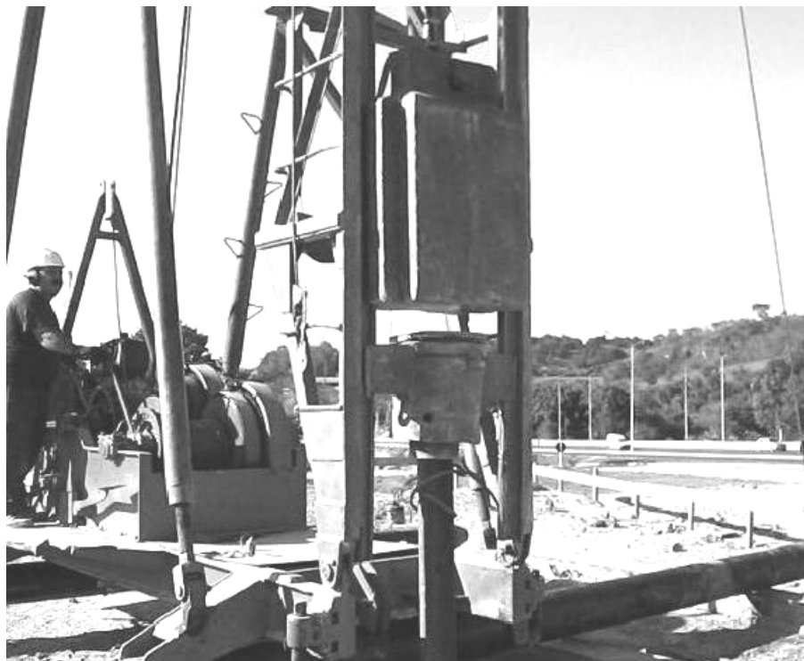
Figura 3.25: Bate estaca de queda livre utilizando martelo de 3 toneladas para cravação de trilhos TR57. Obra de fundação da Empresa Celso Contijo realizado em Belo Horizonte (MAGALHÃES, 2008).
