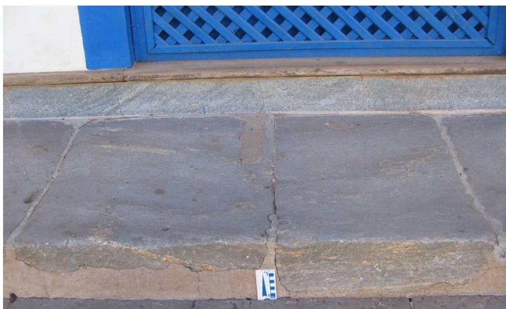
Figura 2.25 - Abaulamento do piso devido a desgaste por abrasão dos pés, em passeio público feito em carbonato-talco xisto. Praça João Pinheiro, Serro-MG. Fotografia capturada em maio de 2008.
