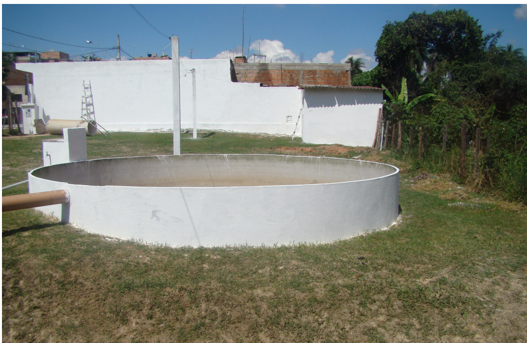
FIGURA 110: ETE Loteamento Vida Nova.
