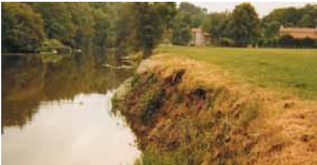
FIGURA 68: Margem de corpo d'água e sua vegetação ripária comprometida.
