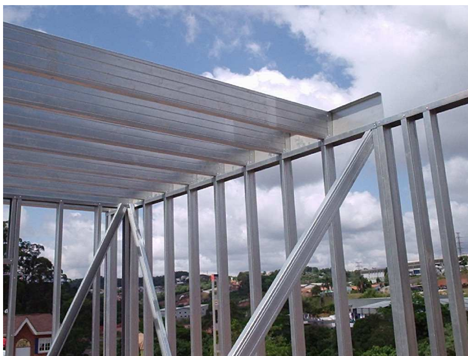
FIGURA 2.22 – Apoio das vigas sobre os montantes do painel (Fonte: arquivo do autor)
