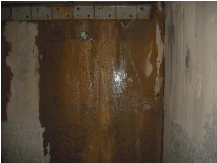
Figura 7.13: Aspecto da estrutura com fluxo constante de água, G-Maia.
