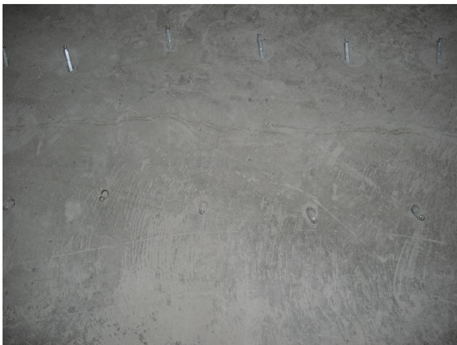
Figura 7.6: Colocação dos bicos injetores nas laterais e ao longo da fissura, G-Maia.
