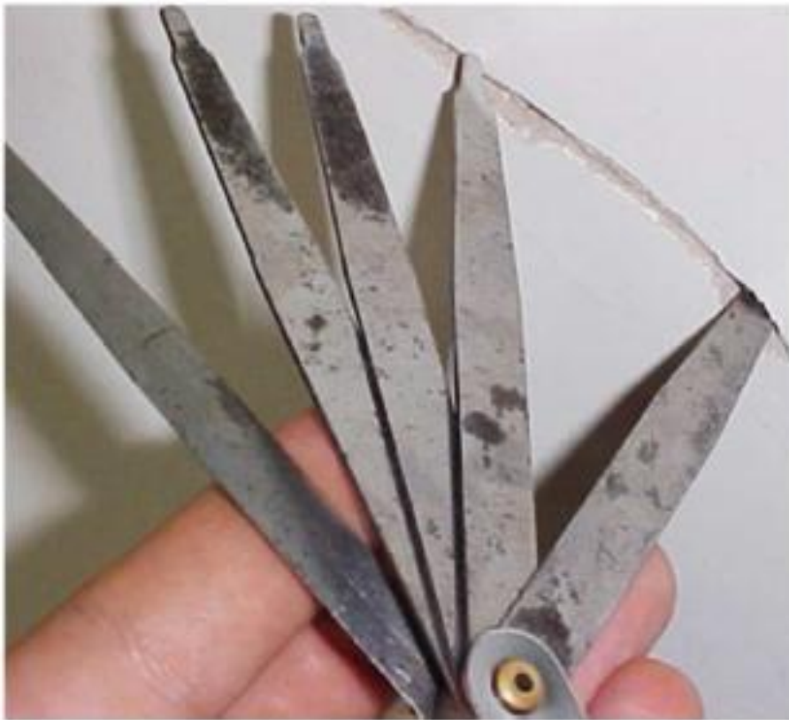
Figura 5.3: Medição de fissura com calibrador de lâmina, Google/Imagens.
