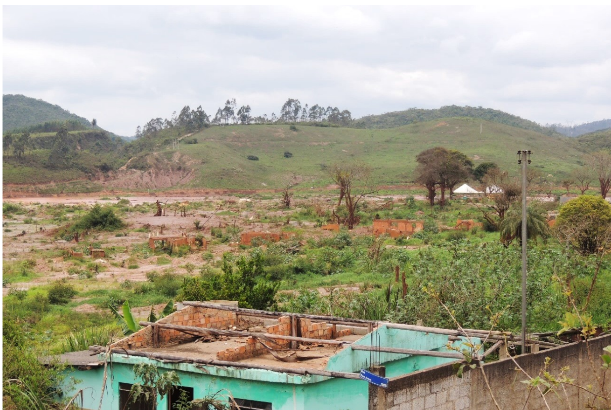
FIGURA 61 Bento Rodrigues um ano após o rompimento da barragem, em 2016.
