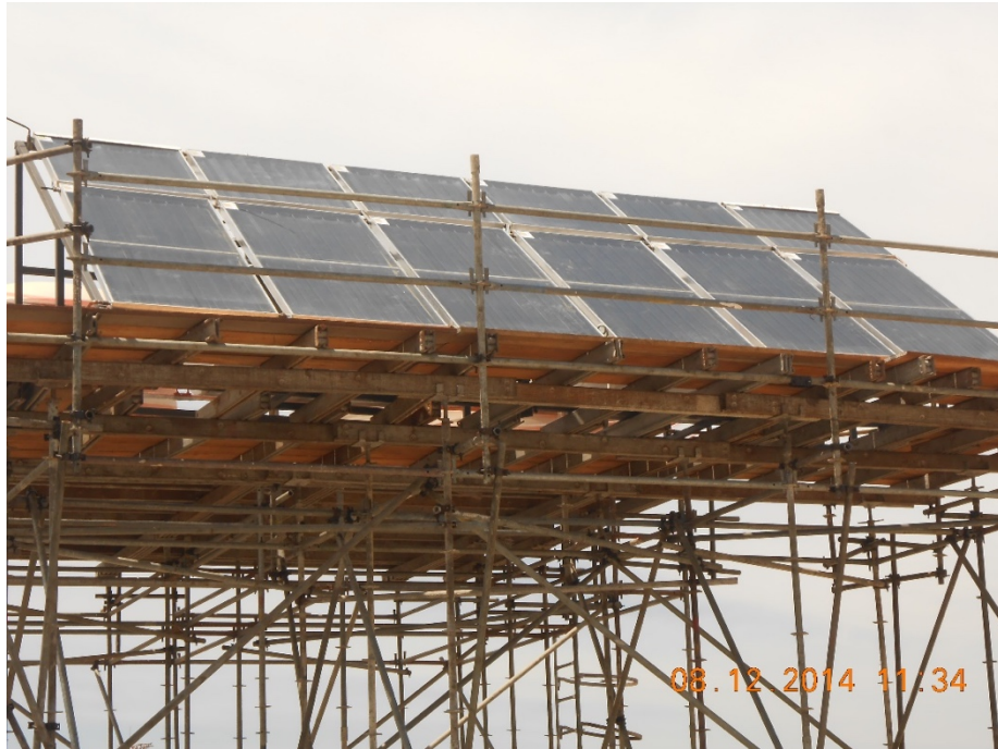
Figura 5.2 – Sistema de aquecimento solar para água. Fonte: PDG Construtora
