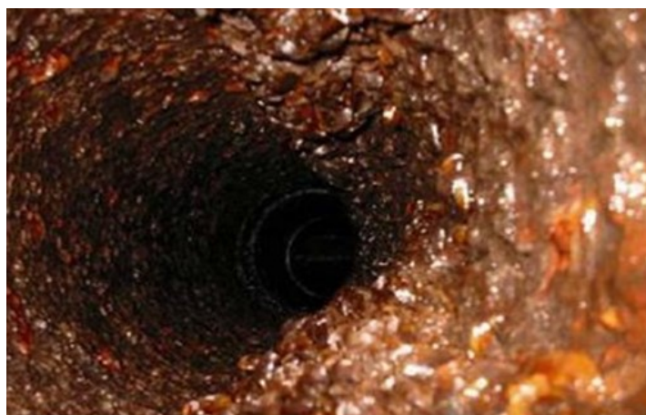
FIGURA 2 - Tubulação infestada pelo MD. FONTE: CORSAN, 2008 apud EBANATAW, 2019.
