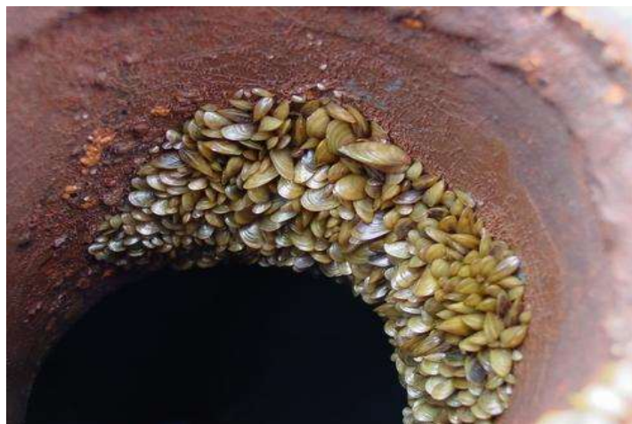
FIGURA 1 - Colônia de MDs em parte de um conduto forçado. FONTE: EBANATAW, 2019.
