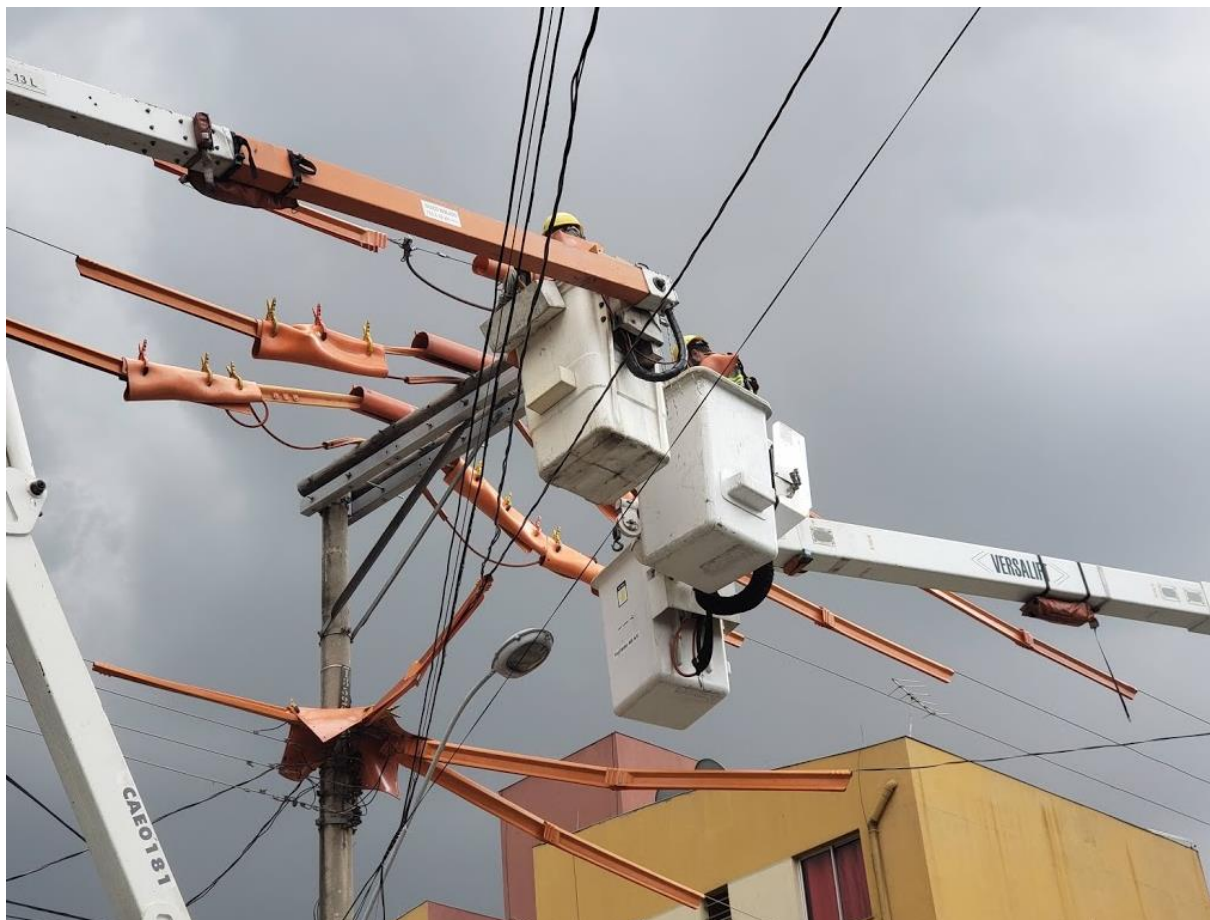
Figura 14 - Condições climáticas e cruzetas roliças e de fibra de vidro concomitantes na mesma estrutura
