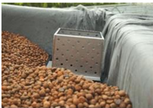
Figura 16 - Substrato de argila expandida. Fonte: www.revistatechne.com.br/engenharia-civil (2011).
