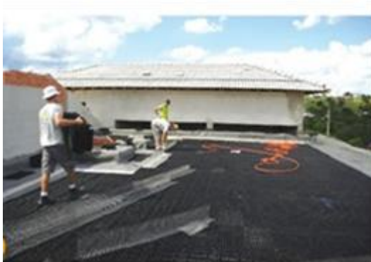
Figura 13 - Elementos de drenagem. Fonte: www.revistatechne.com.br/engenharia-civil (2011).
