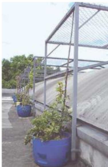
Figura 33 - Telhado verde na Faculdade de Saúde Pública (FSP) da USP. Fonte: www.conpet.gov.br/noticias (2007).
