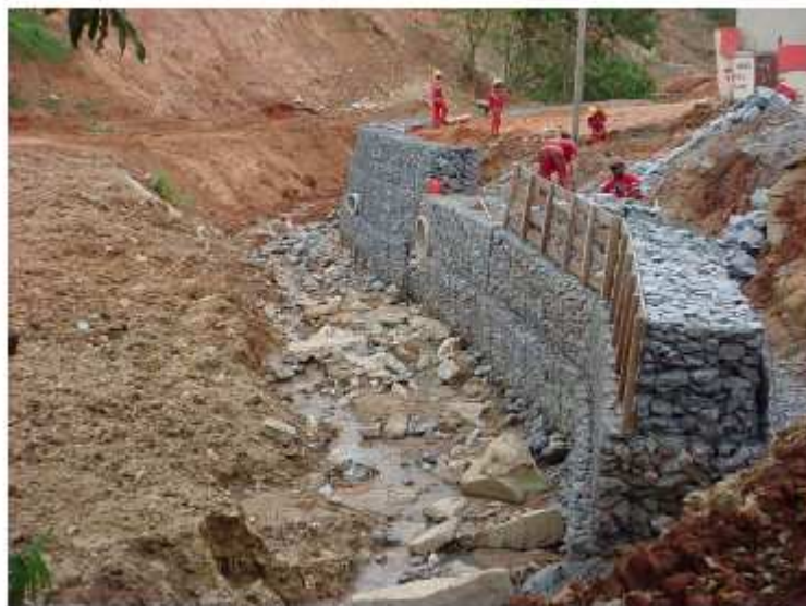
Figura 3.12: Gabiões utilizados para a contenção de encostas do córrego Mergulhão, Belo Horizonte/ MG .Foto: RODRIGO FRANÇA, 2008, apud CARDOSO, 2008, p. 29).
