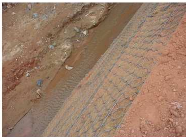
Figura 3.11: Terramesh (tela vegetal) utilizada para a contenção de taludes no córrego Baleares - Belo Horizonte/ MG . Foto: RODRIGO FRANÇA, apud CARDOSO, 2008, p. 27).
