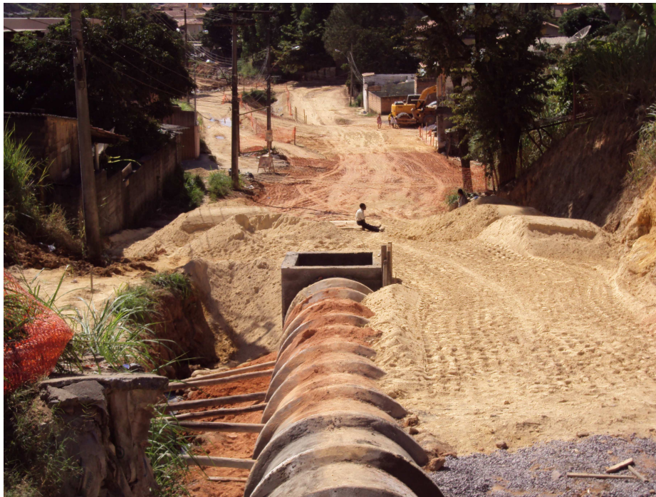
Figura 5.1: Obra em andamento, junho/2010. O Trecho com manilhas será uma pista de rolamento e a jusante, observa-se a abertura da via na margem direita do Cascatinha e início do mesmo em leito aberto. Foto: Guilherme Póvoa.
