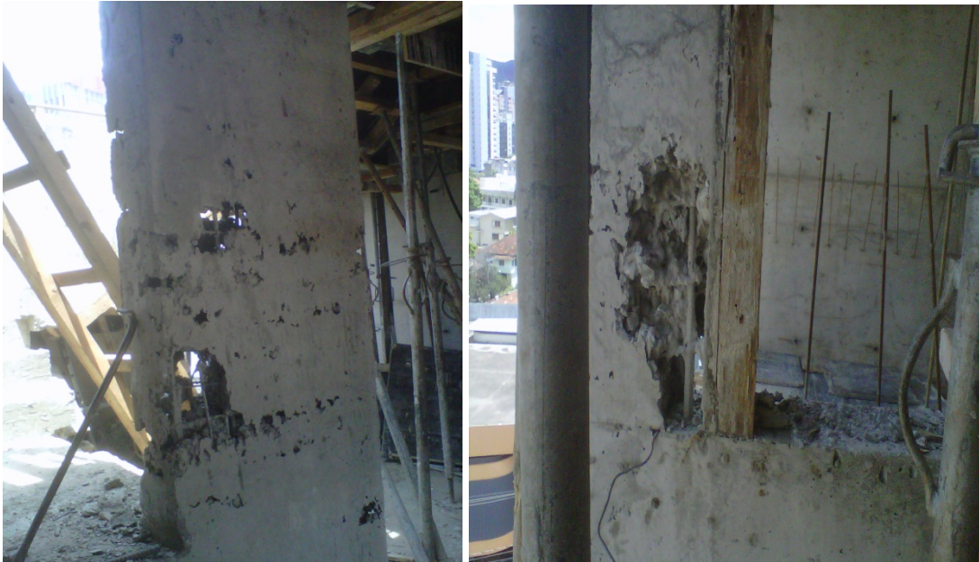
Figura 3.2: Brocas e nichos de falhas na vibração e adensamento do concreto.
