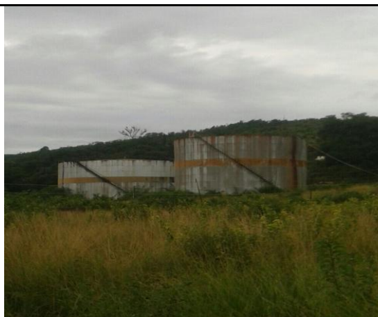
Foto 24: Tanques de álcool abandonados da ex-usina Ariadnópolis.
