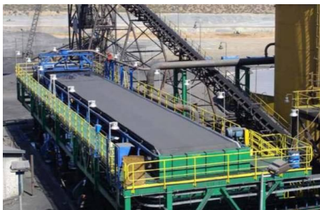
Figura 3.24 – Filtro horizontal de correia de 134m 2 . (31)
