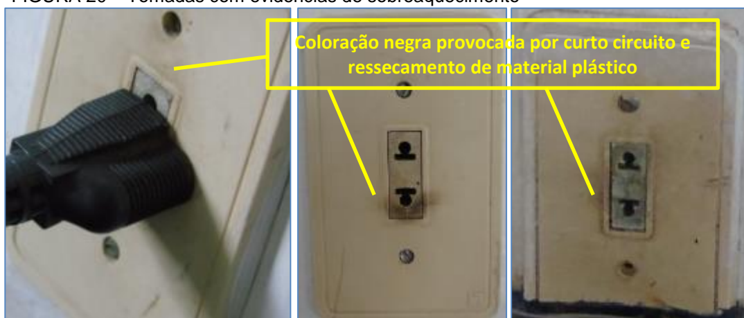
FIGURA 20 – Tomadas com evidências de sobreaquecimento
