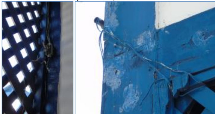
FIGURA 32 – Instalação inadequada de condutores no telhado
