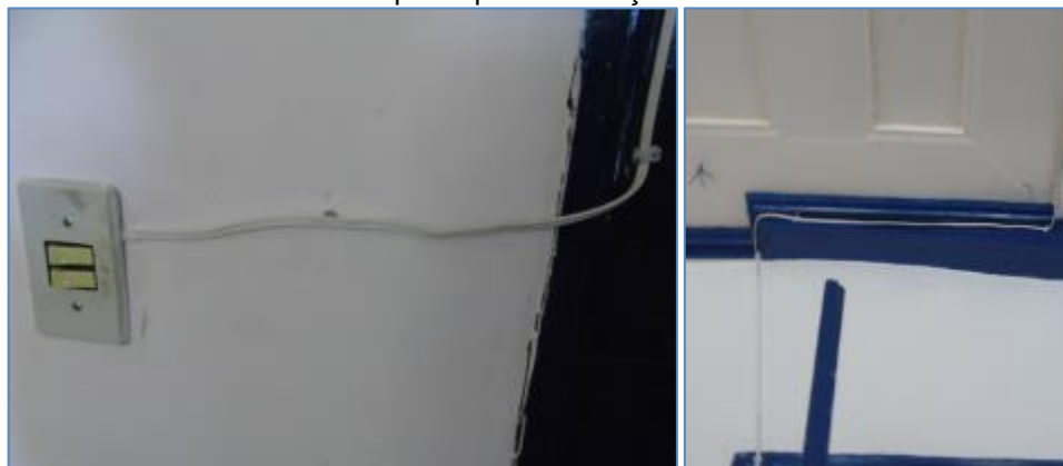
FIGURA 34 – Condutor inadequado para instalações fixas
