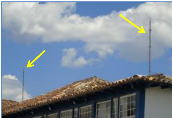
FIGURA 36 – Sistema de captação Instituto Casa da Glória
