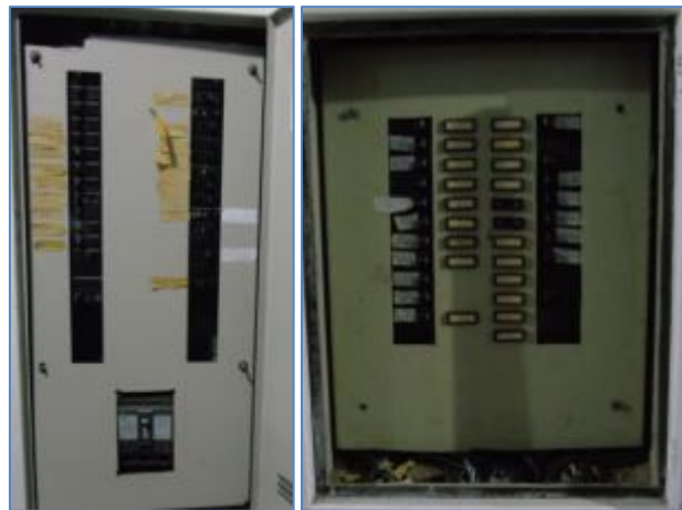
FIGURA 16 – QDC Bloco II – 1° e 2° Pavimentos - Ausência DDR e DPS
