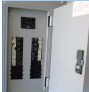
FIGURA 15 – QDC Bloco I - Ausência DDR e DPS
