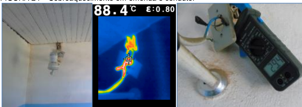
FIGURA 24 – Sobreaquecimento em emenda e condutor
