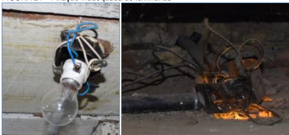
FIGURA 21 – Fixação inadequada de luminárias
