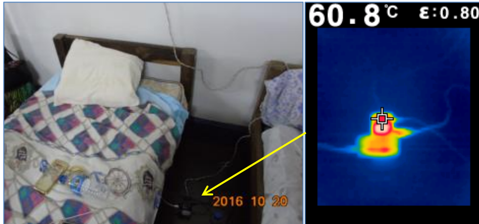
FIGURA 17 – Adaptador com sobreaquecimento e próximo de materiais combustíveis
