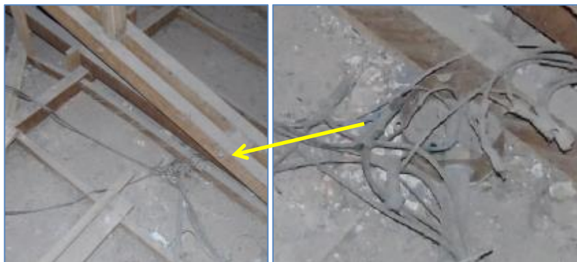
FIGURA 28 – Emenda fora de caixa no telhado
