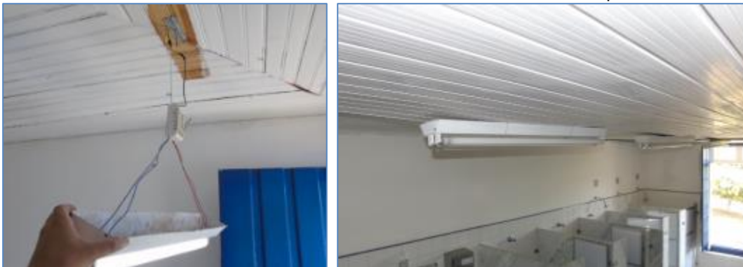
FIGURA 22 – Reator em contato com teto de madeira de acabamento e plástico
