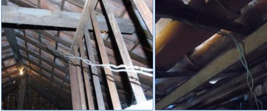
FIGURA 30 – Instalação inadequada de condutores no telhado
