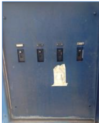
FIGURA 14 – QDC principal (entrada de energia) – Ausência DDR e DPS
