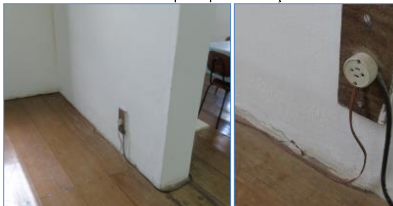
FIGURA 35 – Condutor inadequado para instalações fixas
