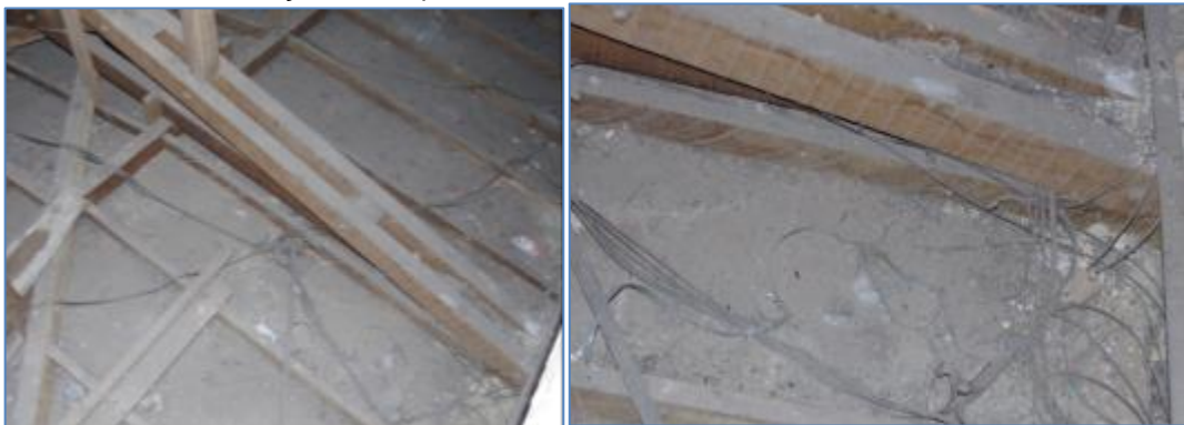
FIGURA 31 – Instalação inadequada de condutores no telhado
