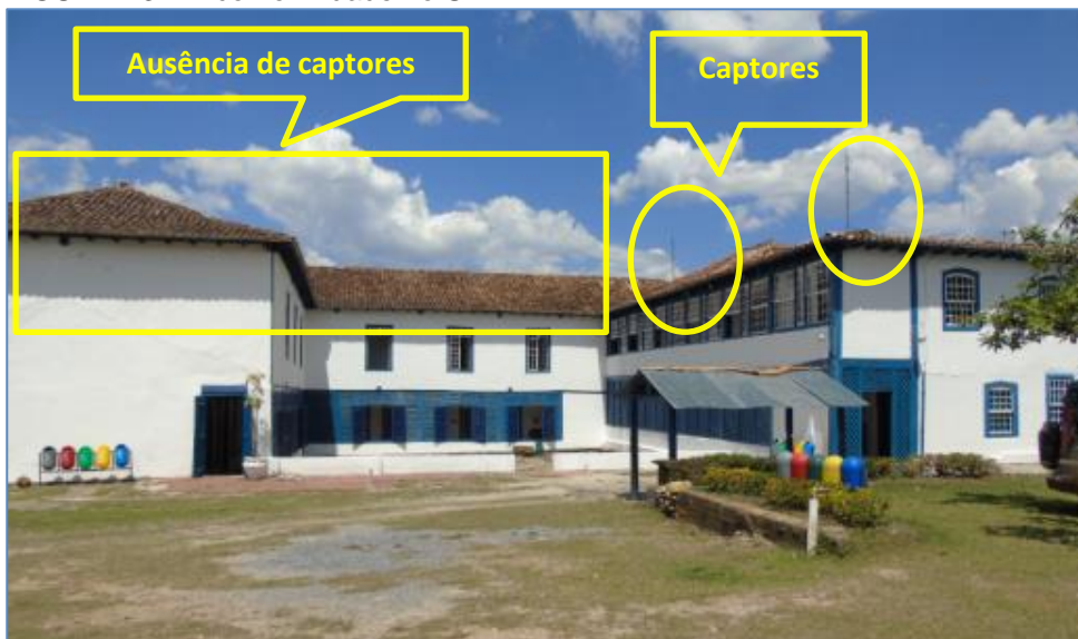
FIGURA 13 – Inconformidade no SPDA
