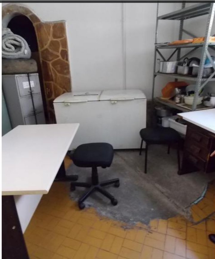
"Piscina" ou tanque em azulejo encoberto por cimento. No lado esquerdo da foto observa-se uma porta com marco em pedra onde funcionava a "sauna".
