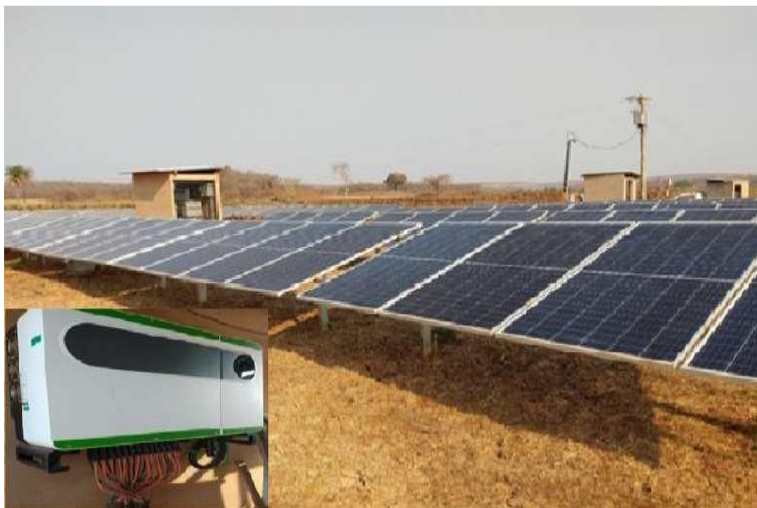
Figura 13 - Usina de Microgeração de Energia Solar Fotovoltaica
