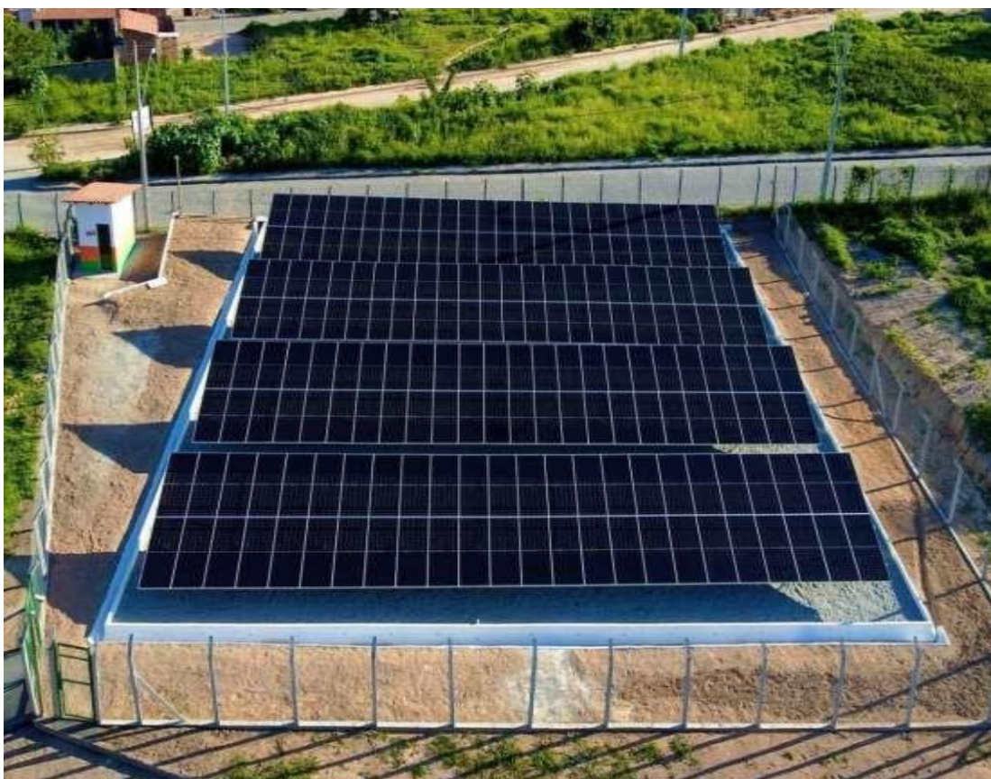
Figura 21 - Usina de Geração Distribuída de Energia Solar Fotovoltaica da EMATER-MG
