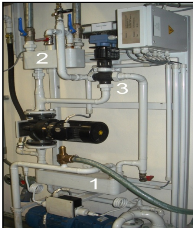
Figura 3.31 - Condicionador de óleo.
