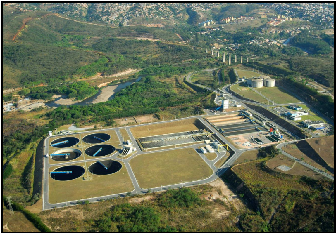
Foto 1 – Vista Superior da ETE Arrudas
