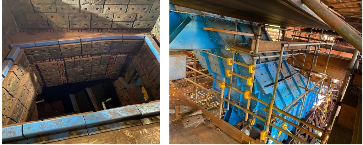
Figura 30: Chute de Transferência
