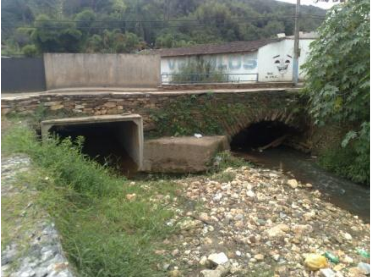
FIGURA 20 - “Restauração” da ponte do Moinho realizada pelo poder executivo municipal Fonte: fotografia da autora, 31 de mai. 2012
