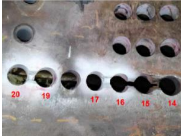
Figura 6 - Detalhe do andamento da remoção das trincas identificadas nos orifícios da parede lado esquerdo do banco de tubos.
