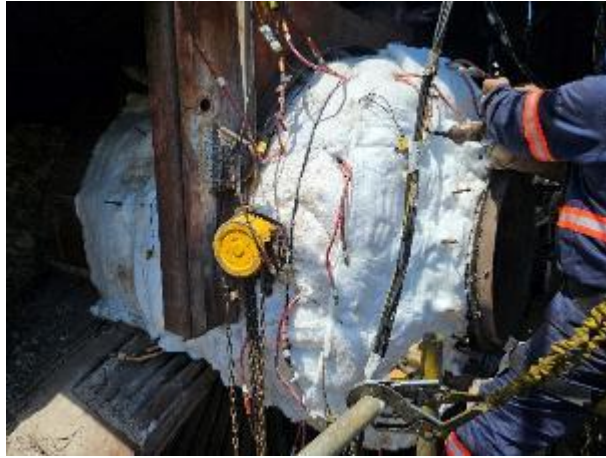
Figura 10 – Aquecimento por resistência elétrica no tubulão de vapor.
