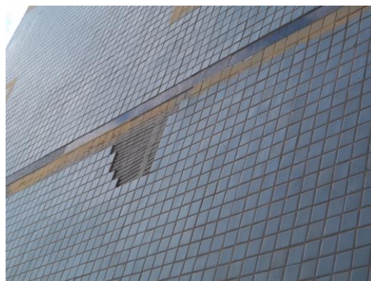
Foto 02 – Destacamento cerâmica Fonte: Autora
