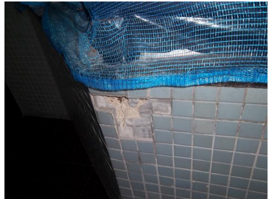
Fotos 12, 13: Má execução do emboço Fonte: Autora
