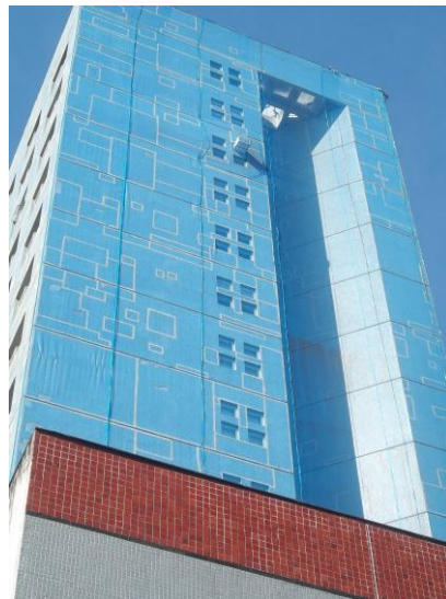
Fotos 20: Tela de proteção Fonte: Autora
