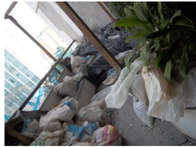
Foto 28 –Sujeira na obra Fonte: Autora
