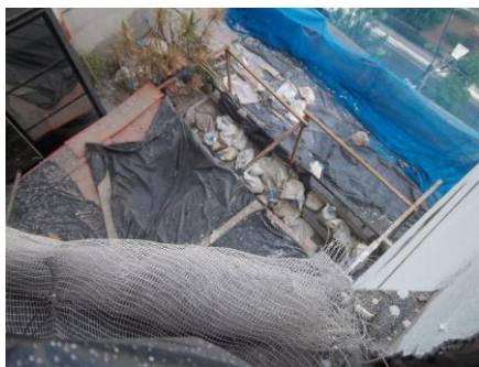
Foto 23 – Resíduo na obra Fonte: Autora
