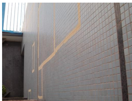
Foto 04 – Destacamento cerâmica Fonte: Autora
