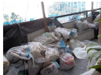
Foto 24 – Resíduo na obra Fonte: Autora
