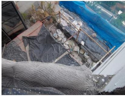
Foto 27 –Sujeira na obra Fonte: Autora
