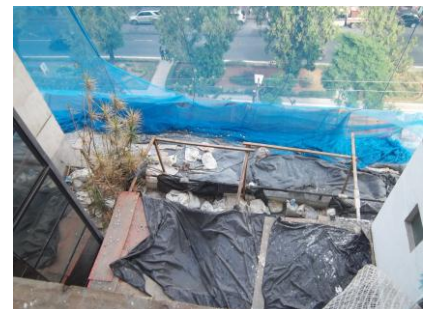
Foto 26 – Resíduo na obra Fonte: Autora
