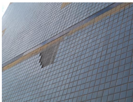
Foto 07 – Destacamento cerâmica Fonte: Autora
