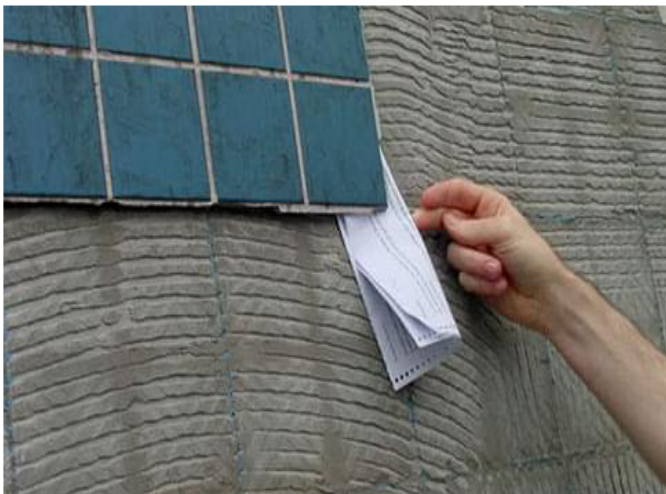
Figura 5: Destacamento de revestimento cerâmico assentado com argamassa colante.
