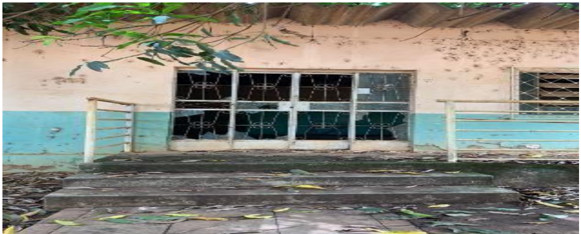
Figura 12 – Foto do prédio antigo da Associação Quilombola da Pontinha antes da reforma
