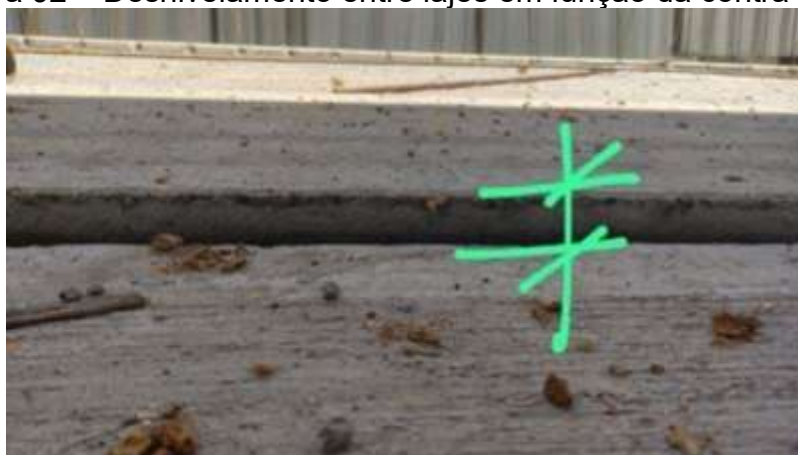
Figura 92 – Desnívelamento entre lajes em função da contra flecha
