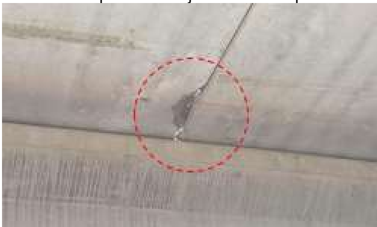
Figura 88 – Detalhe de quebra em laje durante seu posicionamento.
