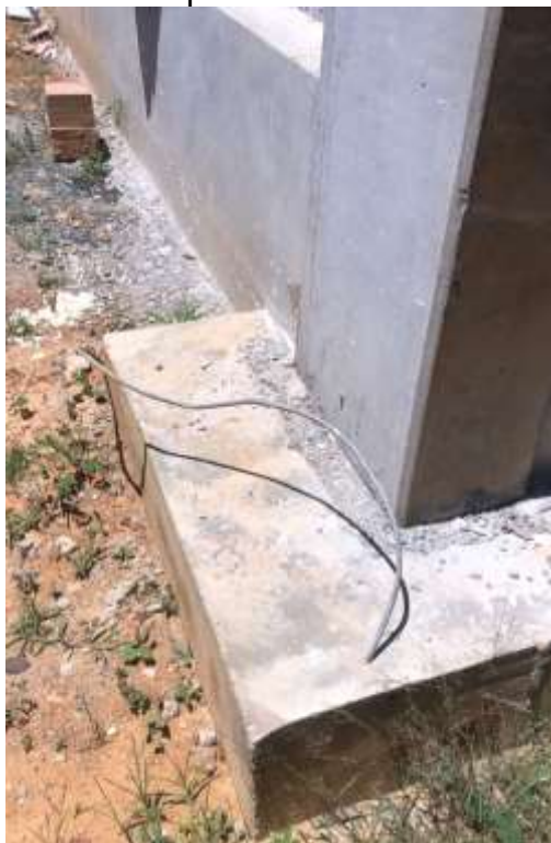
Figura 76 – Detalhe de barra para ligação do aterramento estrutural no bloco e no pilar - SPDA
