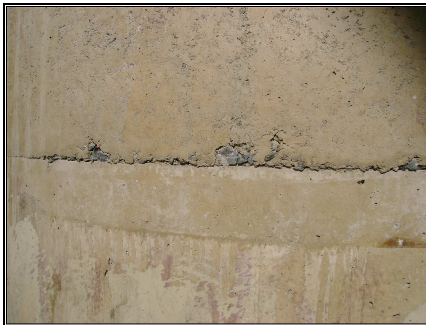
FIGURA 02 - Falha na emenda da fôrma.
