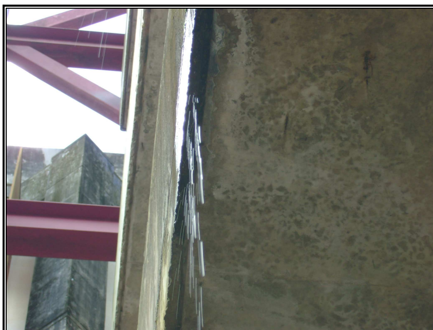
FIGURA 05 - Escoamento de água na superfície do concreto.
