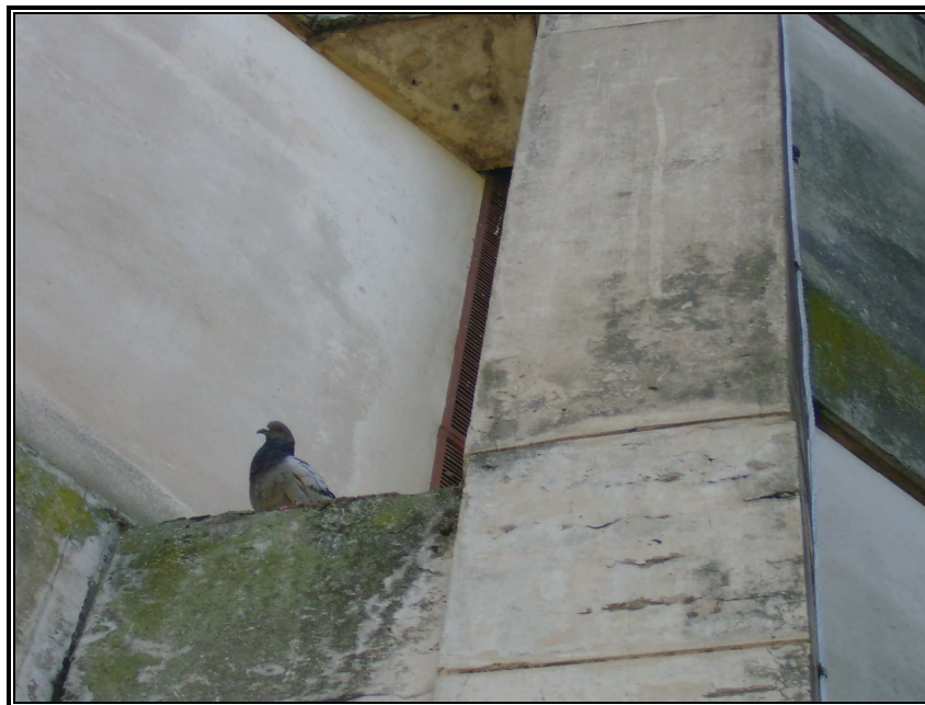
FIGURA 04 - Locais onde aves pousam na estrutura.
