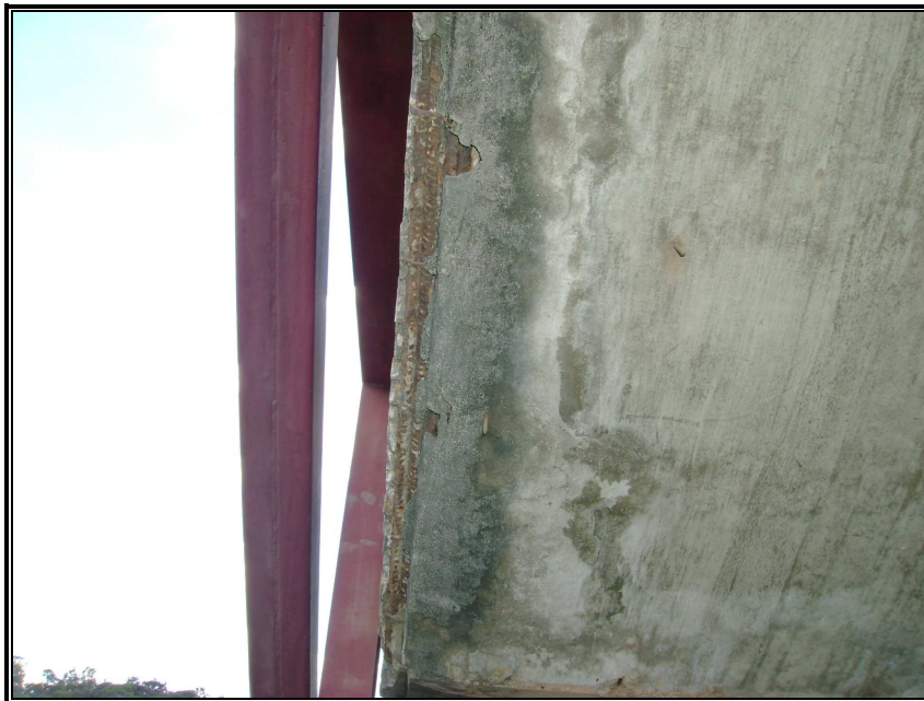
FIGURA 07 - Congestionamento de barra de aço.
