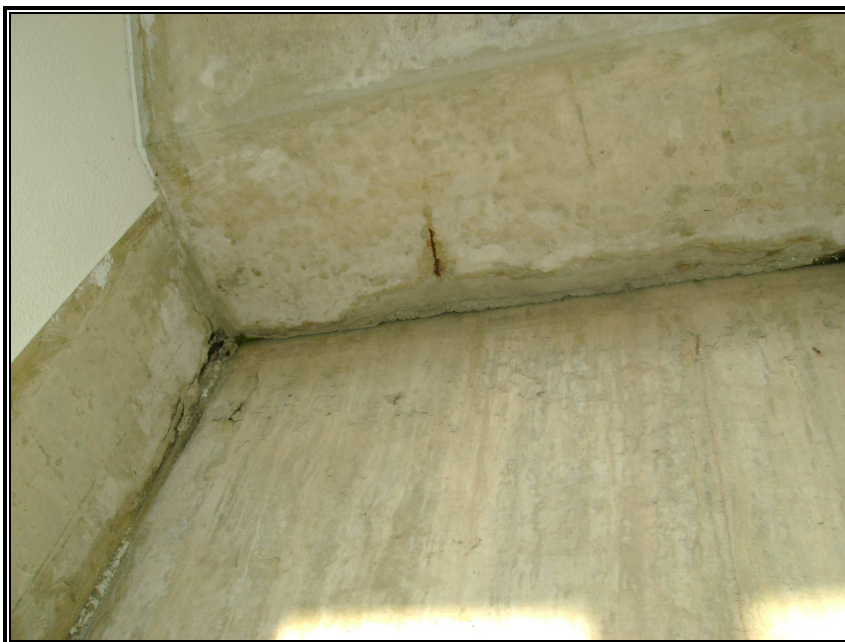
FIGURA 08 - Falta de selagem da junta de dilatação.
