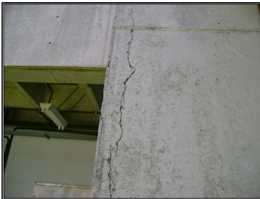
FIGURA 11- Fissura vertical em pilar de concreto aparente.
