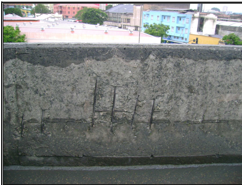
FIGURA 03 - Guarda roda de viaduto com armadura de aço exposta.
