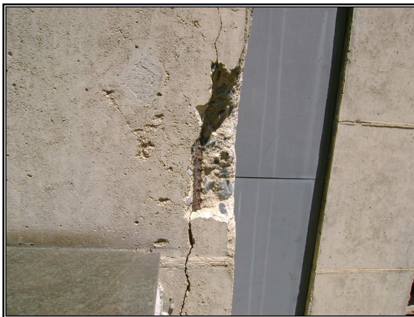
FIGURA 13 - Corrosão da armadura.
