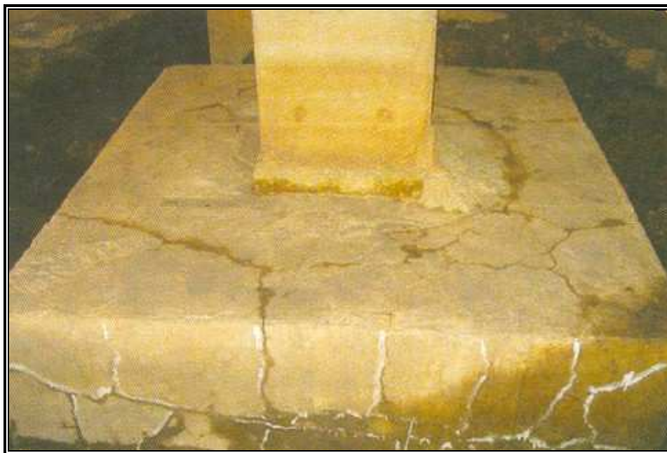
FIGURA 16: Mapeamento de fissuras em blocos de fundação devido à reação álcali-agregado.
