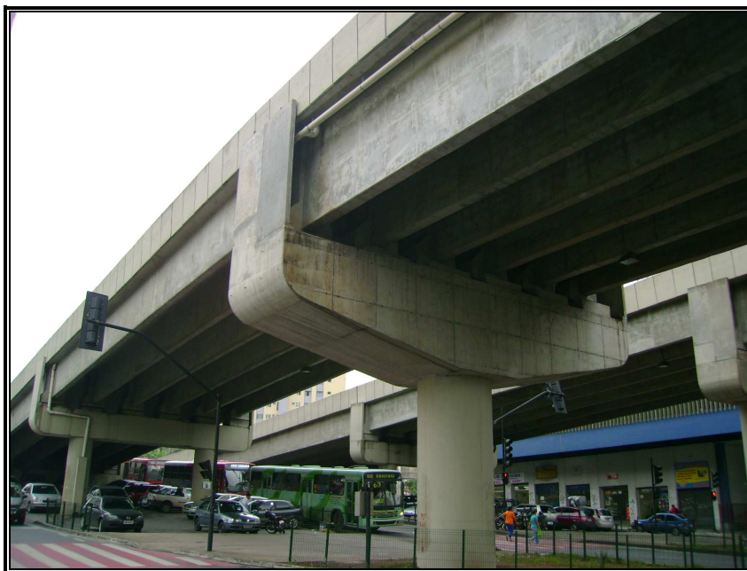
FIGURA 18 - Estrutura em concreto aparente sem proteção superficial.
