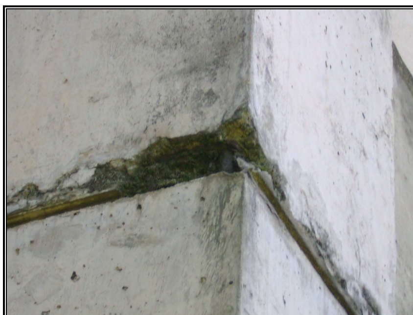
FIGURA 14 - Quinas quebradas nas vigas de concreto.
