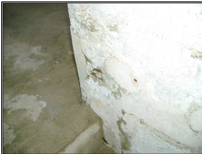
FIGURA 06 - Umidade na parede de concreto.
