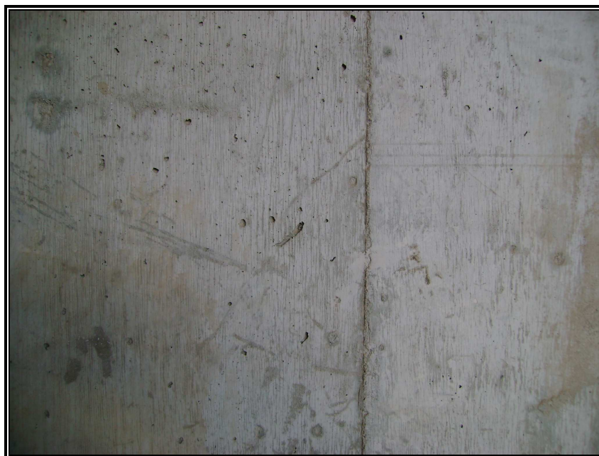
FIGURA 01- Bolhas de ar na superfície do concreto.
