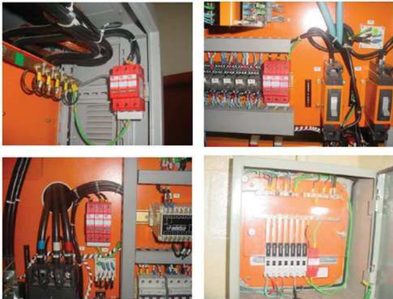
Fig. 8.14 – Fotografias de instalações típicas de DPS em redes elétricas.
