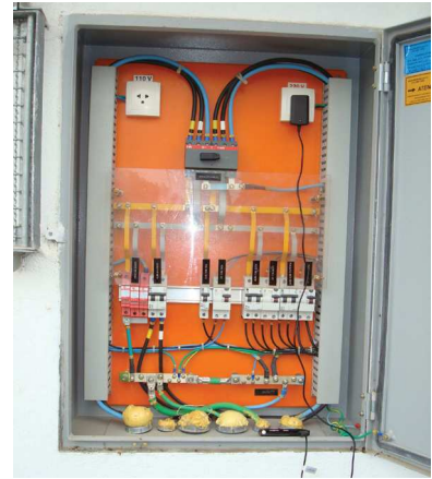
Fig. 9.19 - DPS Classe I modelo VCL 275V 12,5/60kA aplicado na entrada da instalação, próximo ao medidor de energia da concessionária de energia.
