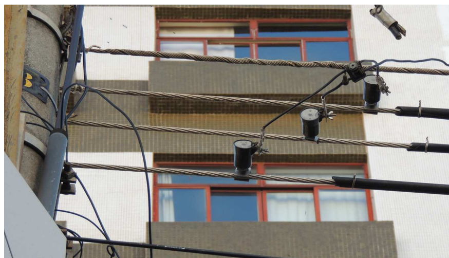
Fig. 9.5 Detalhe de instalação de PRBT no secundário de um transformador.
