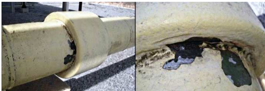
Fig. 10.12 Rompimento de isolamento em junta monobloco devido a descarga atmosférica – Fonte: GASMIG.
