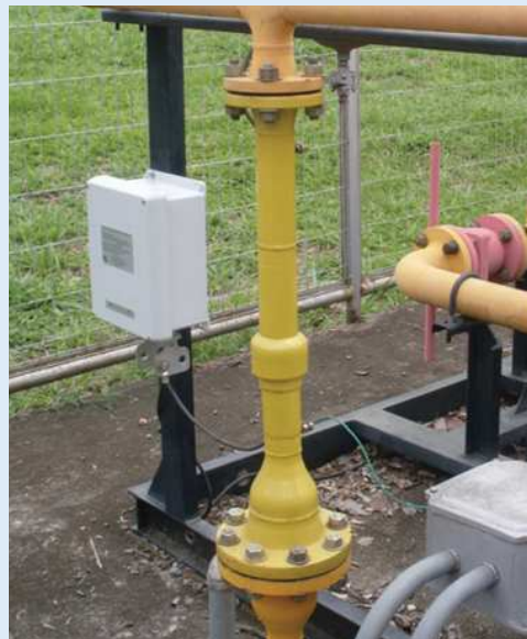
Fig. 10.19 Protetor desacoplador de corrente alternada modelo DDCC instalado no citygate.
