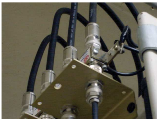
Fig. 9.22 – DPS modelo 812.X.050/N instalado na entrada do prédio ou container.
