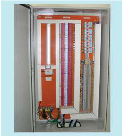
Fig.10.35 – DPS Classe I instalados na entrada do abrigo para proteção de sinais de sinalização ferroviária.
