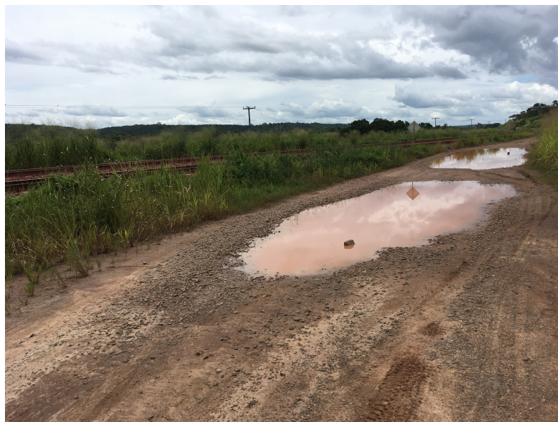
Figura 17: Poças temporárias encontradas em estrada de acesso à Estrada de Ferro Carajás.
