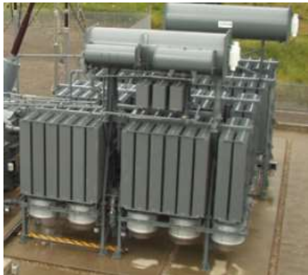
Figura 2.17 – Transformador de potência com radiadores e ventilação forçada.
