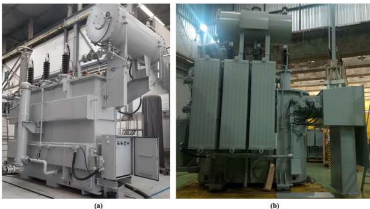
Figura 2.8 – Fotos de transformadores de 69 kV (a) Forno-Panela (b) Convencional
