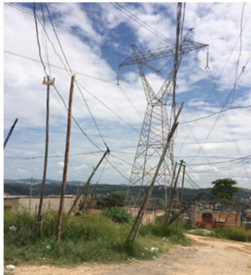
Figura 36 - Vista Conjunto Paulo VI- Ocupação sob linha de alta tensão
