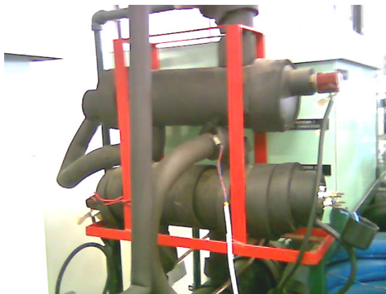
Figura 3.9 -Fotografia do sub-resfriador
