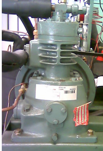
Figura 3.4 -Fotografia do compressor Bitzer.
