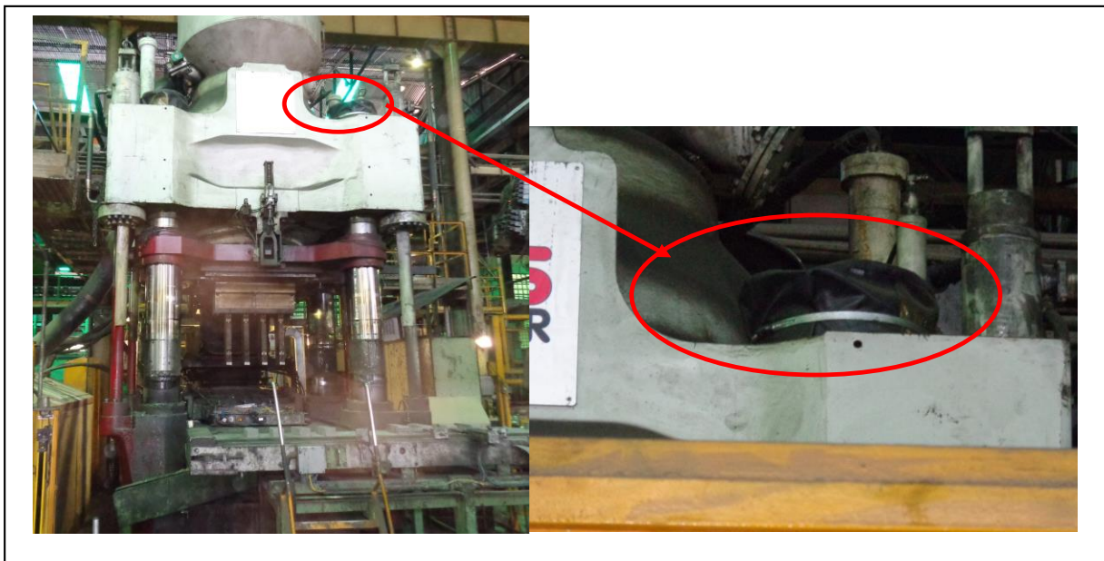
FIGURA 2.4 - Prensa hidráulica vertical de 20.000 kN, com suas quatro colunas estruturais e uma aproximação do sistema de fixação chamado de Superbolt™. O mesmo permanece protegido com um plástico contra contaminação do ambiente.
