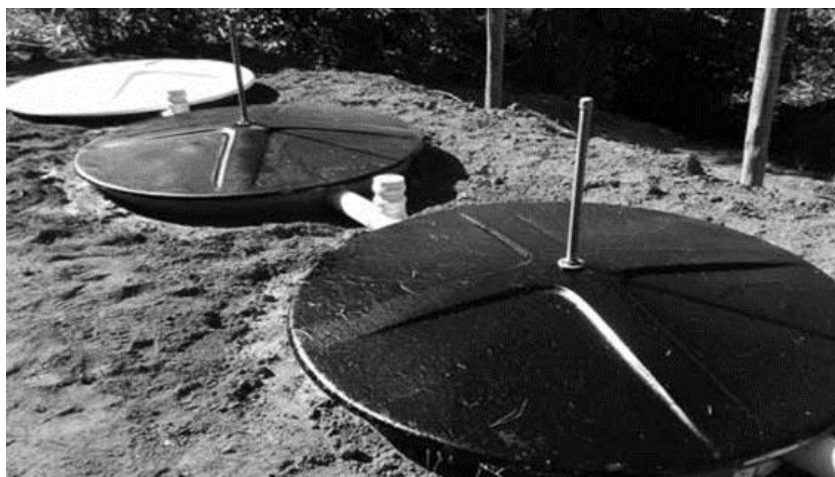
Figura 3 - Fossa séptica biodigestora
