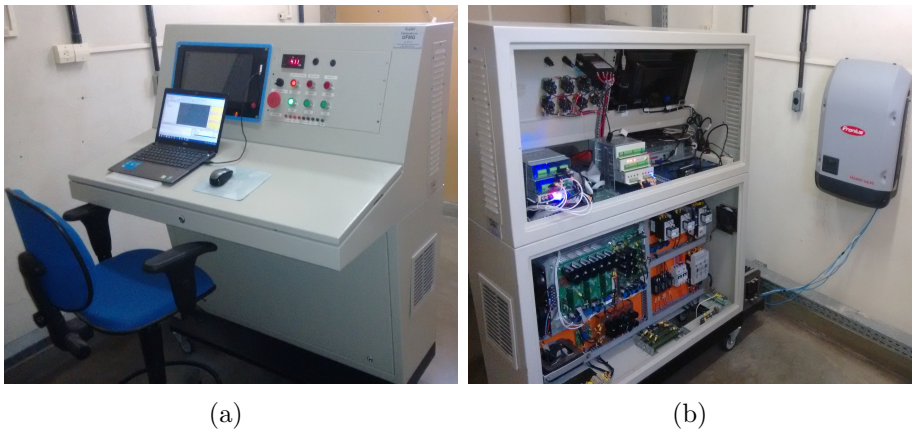
Figura 2.8: Visão geral do protótipo: (a) Painel frontal (Programação e sistema supervisão); (b) Circuitos de controle, potência e inversor sob teste.
