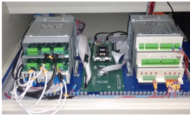
Figura 2.11: Sistema de condicionamento e controle do simulador de painéis.
