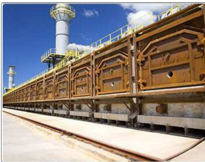
Figura 3.8 – Bateria de coque – Vista das portas.
