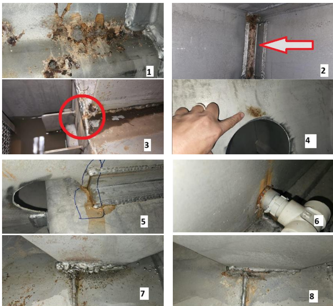
Figura 25 – fotos do 1º tanque e seus defeitos de fabricação
