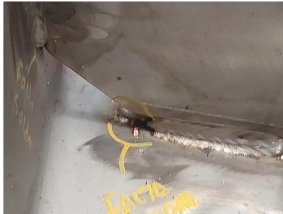
Figura 29 - Falta de soldagem
