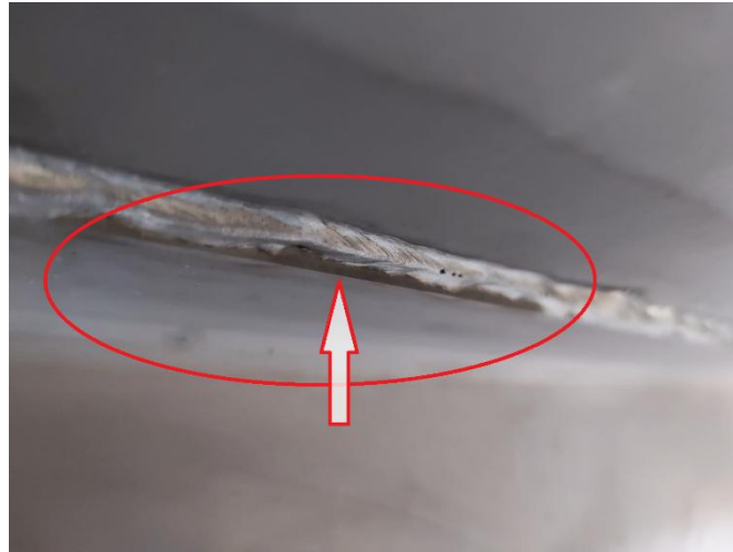
Figura 27 – falta de fusão na junta entre chapas.
