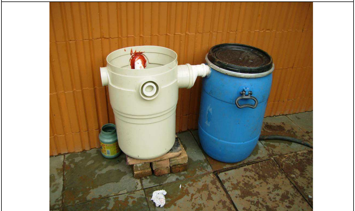
Figura 43 - Caixa de gordura e filtro instalados Fonte: José Geraldo de Souza
