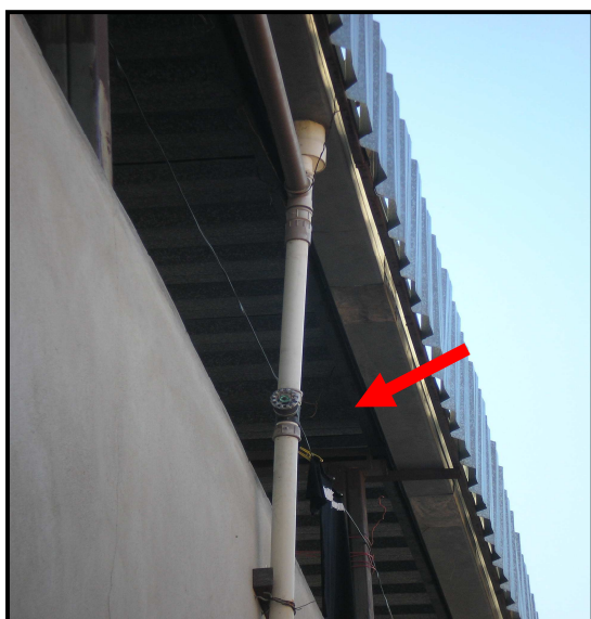
Foto 01: Registro Bruto de 1 1/2', para troca de fluxo da água
