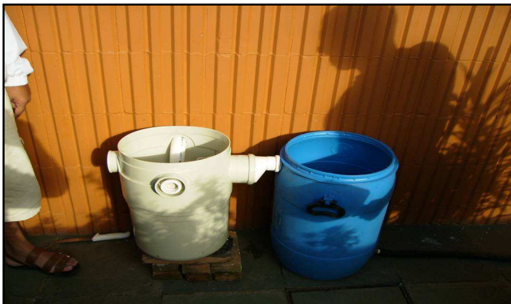
Foto 33: Caixa de gordura e filtro instalados Fonte: José Geraldo de Souza
