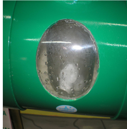
Detalhe do Clorador de pastilhas
