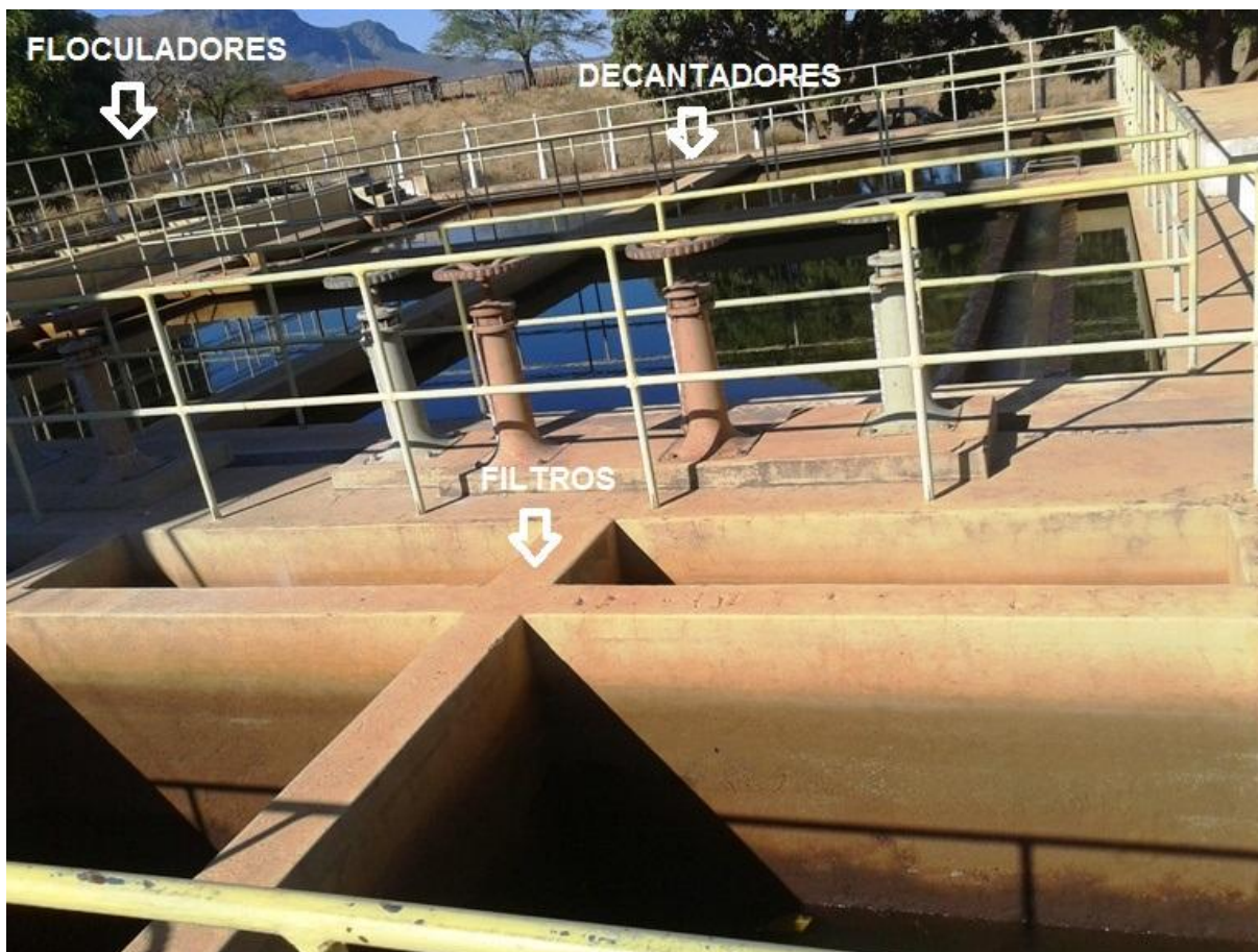
Figura 35 – Vista para a unidade de tratamento de água de Monte Azul.
