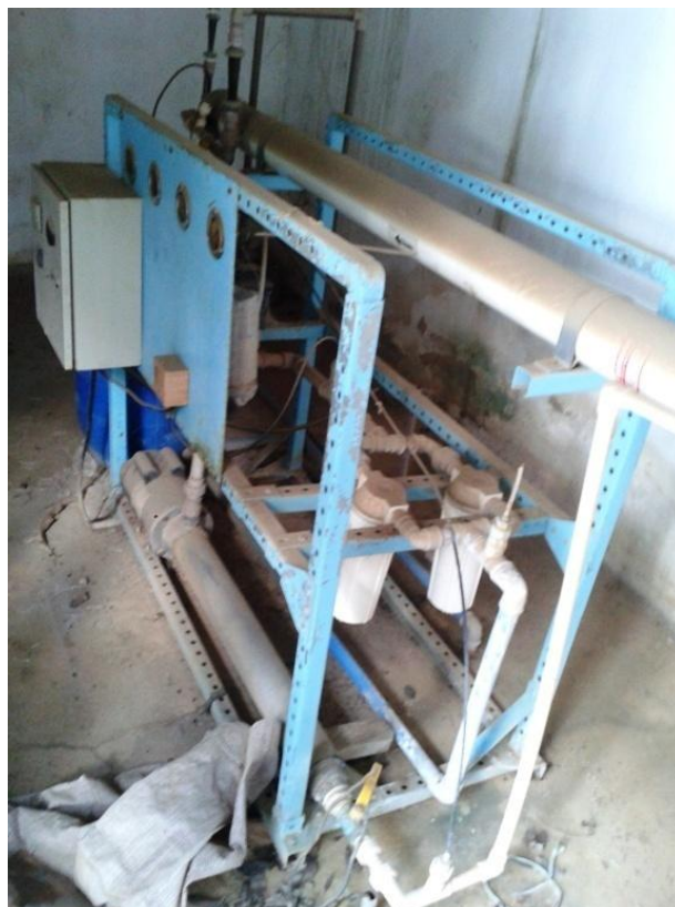
Figura 39 – Dessalinizador inutilizado na localidade de Poções devido à falta de manutenção.
