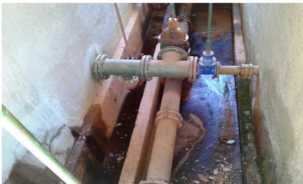
Figura 33 – Vazamento existente na parede externa do tanque de contato.
