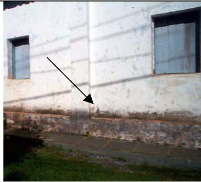
f - Manchas de umidade pelos respingos de chuva
