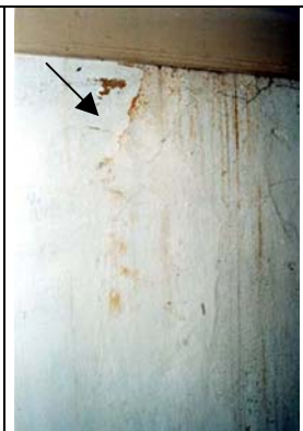
i - Mancha de umidade na parede do Coro
