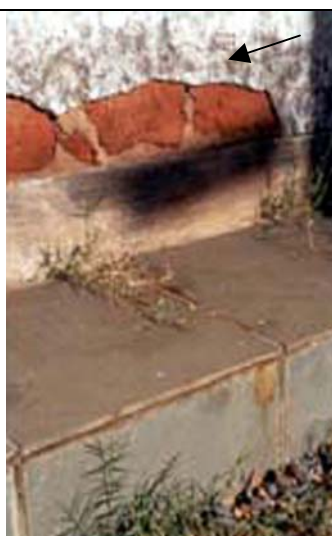
b – perda de reboco
