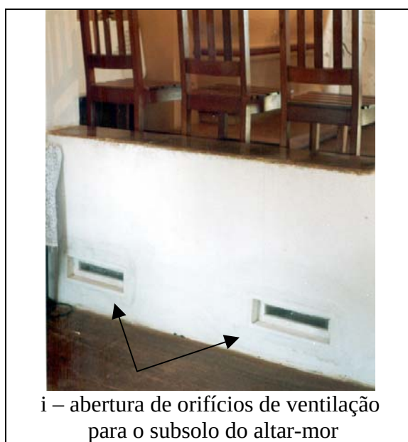
FIGURA 46 – Sistema de ventilação/aeração passiva
