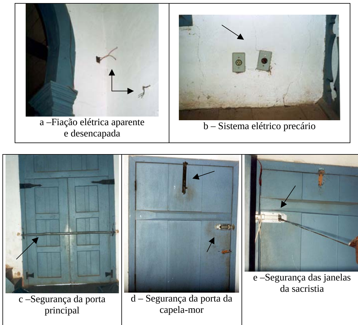
FIGURA 39 – Sistema de segurança e instalações elétricas
