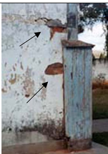
a – reboco com perda e em desprendimento
