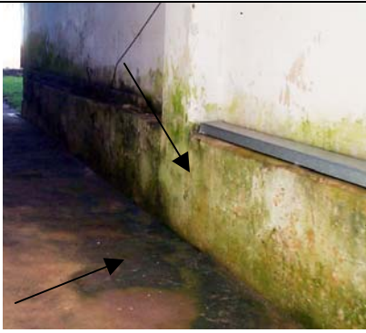
e - Parede com microorganismos entre anexo e fachada posterior da edificação
