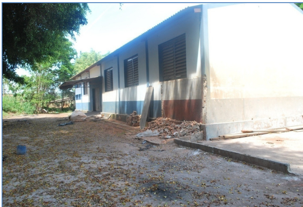
FIGURA 48 – Lateral do galpão para funcionamento da separação dos resíduos sólidos Fonte: Secretaria de meio ambiente de Mateus Leme, 2009.
