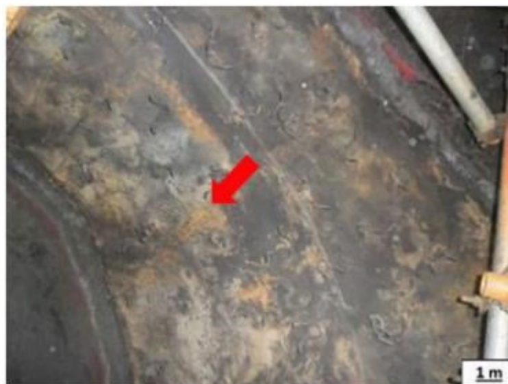
Figura 25 – Processo corrosivo nos grampos de ancoragem do riser. Fonte: PETROBRAS, 2022.
