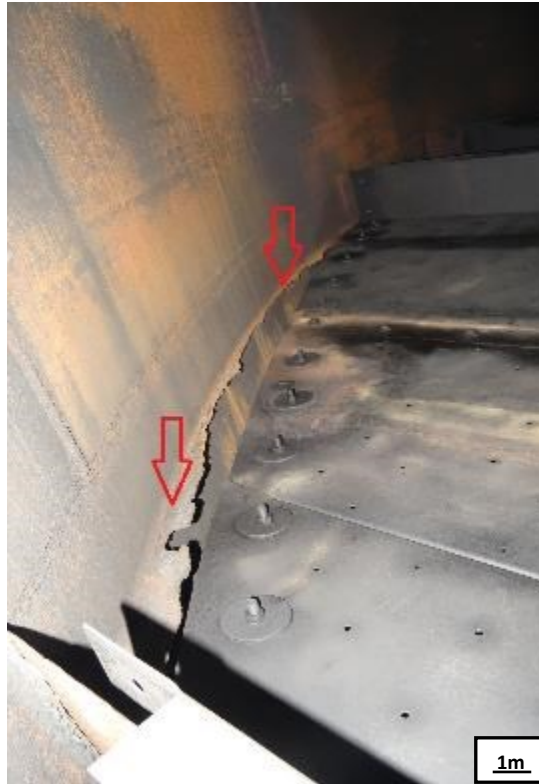
Figura 45 – Perda de espessura do anel de suportação da torre. Fonte: PETROBRAS, 2022.
