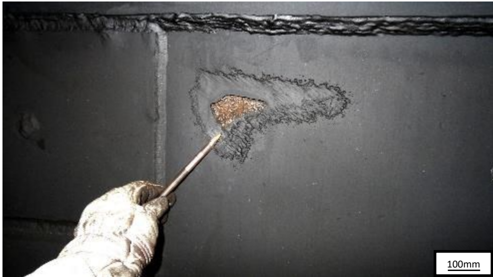
Figura 47 – Corrosão naftênica com perfuração da camada de revestimento em aço inoxidável ferrítico.
