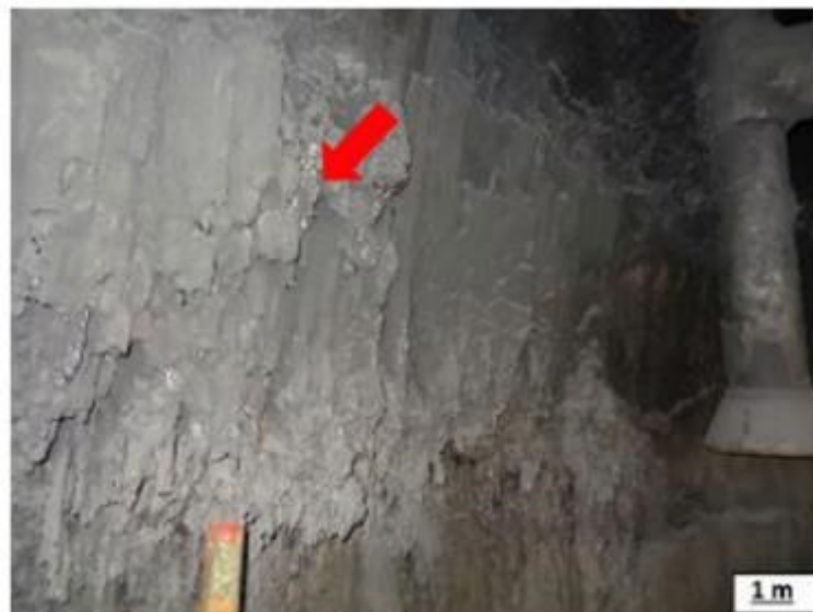
Figura 23 – Camada de coque recobrimo o revestimento refratário. Fonte: PETROBRAS, 2022.
