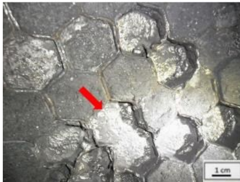
Figura 16 – Amostras do concreto refratário retiradas do riser do conjunto conversor. Fonte: PETROBRAS, 2022.
