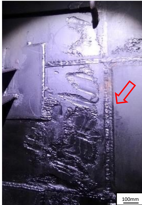
Figura 49 – Corrosão naftênica na junta soldada do costado da torre. Fonte: PETROBRAS, 2022.
