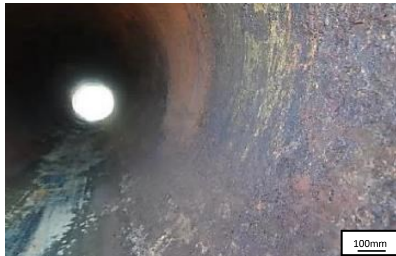
Figura 10 – Corrosão na superfície interna do casco do trocador de calor. Fonte: PETROBRAS, 2019.
