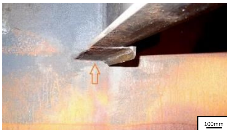
Figura 44 – Perda de espessura nos suportes das bandejas da torre. Fonte: PETROBRAS, 2022.
