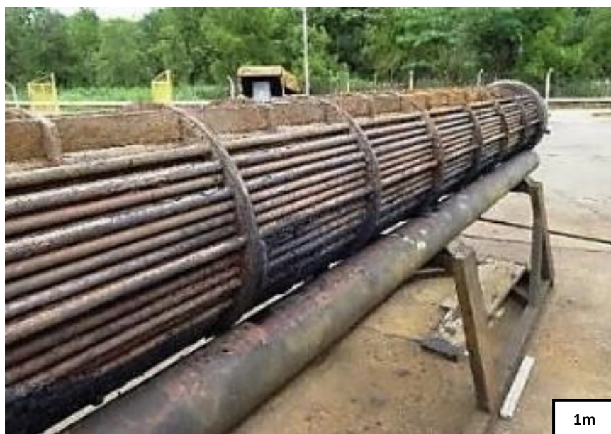
Figura 11– Processo corrosivo no feixe tubular do trocador de calor. Fonte: PETROBRAS, 2019.
