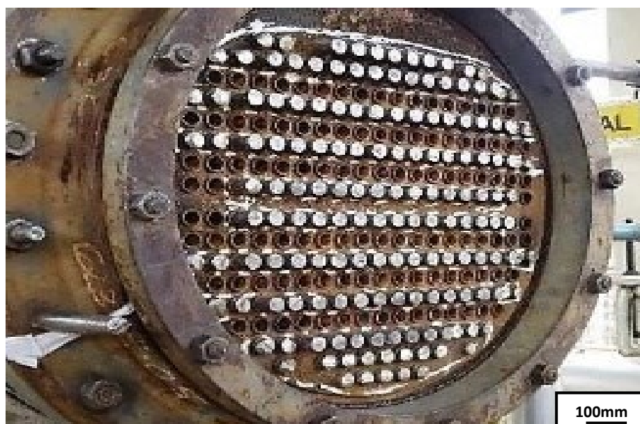
Figura 13 – Plugueamento ocorrido nos tubos do trocador de calor. Fonte: PETROBRAS, 2019.
