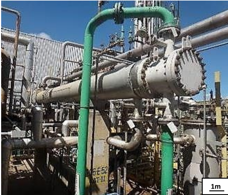
Figura 31 – Trocador de calor do sistema de topo da torre regeneradora de DEA. Fonte: PETROBRAS, 2022.
