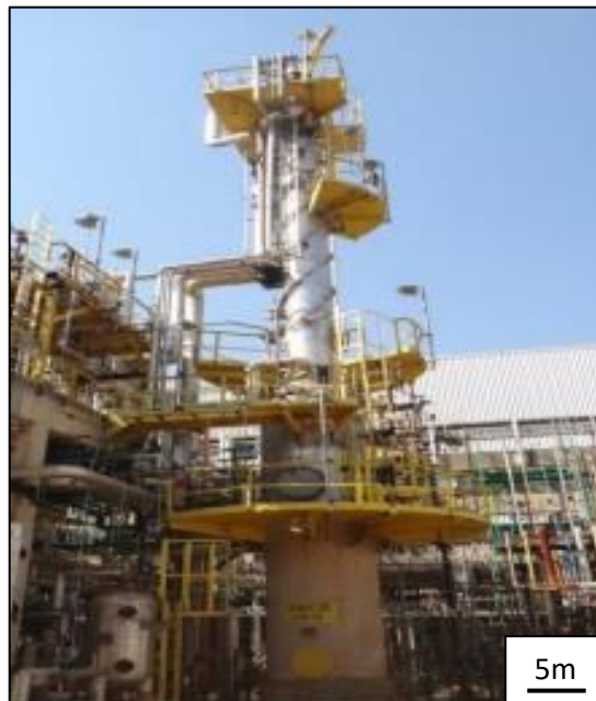
Figura 32 – Torre regeneradora da DEA. Fonte: PETROBRAS, 2022.
