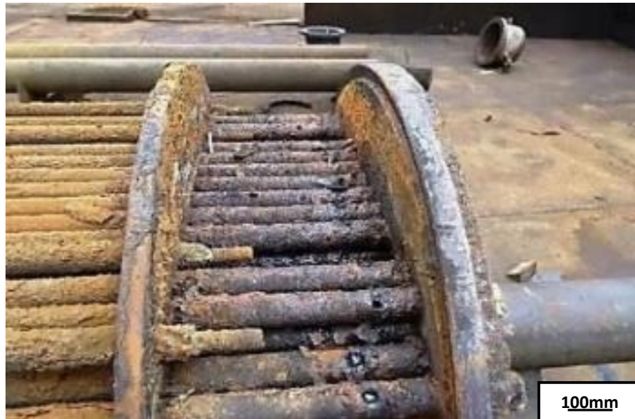
Figura 12 – Processo corrosivo no feixe tubular do trocador de calor. Fonte: PETROBRAS, 2019.
