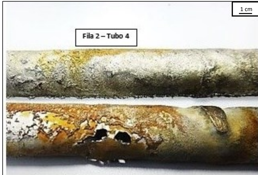
Figura 37 – Corrosão detectada nos tubos do trocador de calor. Fonte: PETROBRAS, 2020.
