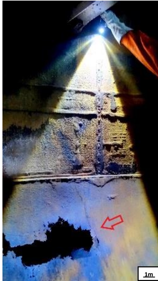
Figura 43 – Corrosão naftênica na região intermédia da torre. Fonte: PETROBRAS, 2022.
