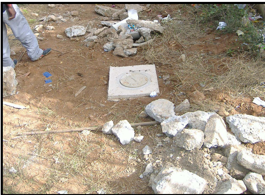
Figura 4: Identificação da fossa “desativada”.
