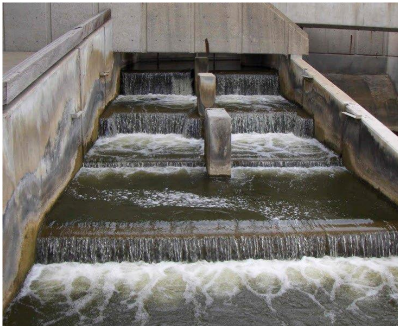
Figura 6: Foto de um MTP tipo tanque com vertedor
