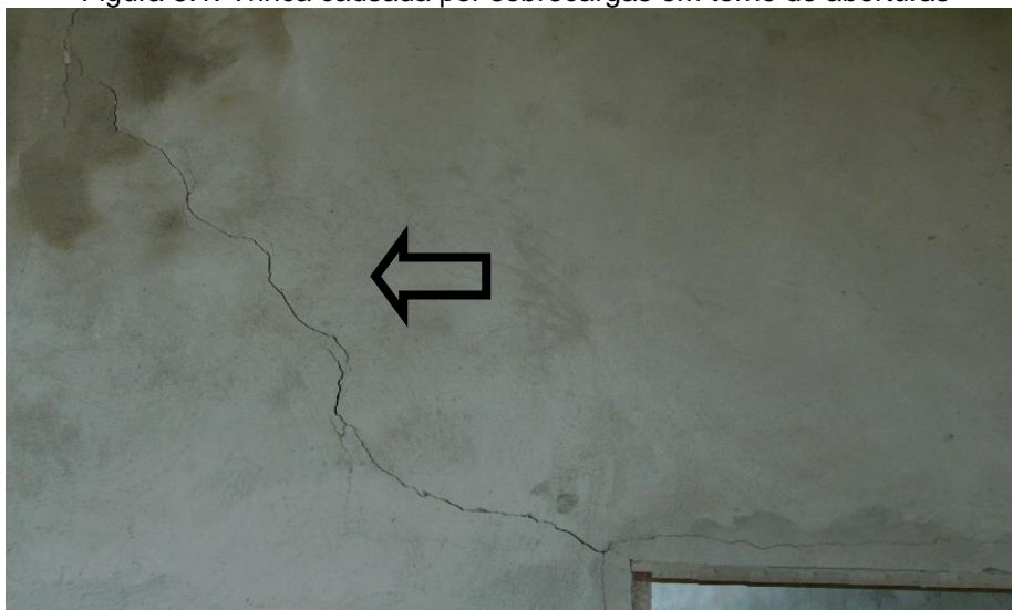
Figura 5.1: Trinca causada por sobrecargas em torno de aberturas
