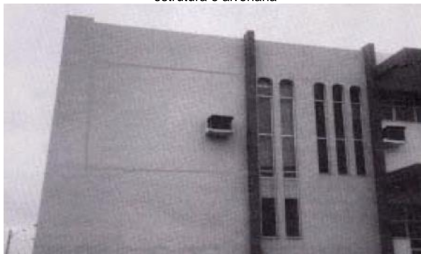
Figura 3.8: Aparecimento de fissuras horizontais e verticais devido ao destacamento entre estrutura e alvenaria
