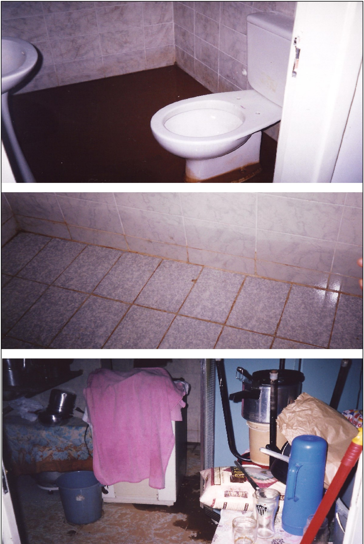
Figura 4.9 - Aspecto dos revestimentos cerâmicos e louça sanitária após inundação em novembro de 2010 – Av. Tereza Cristina, Belo Horizonte - MG.
