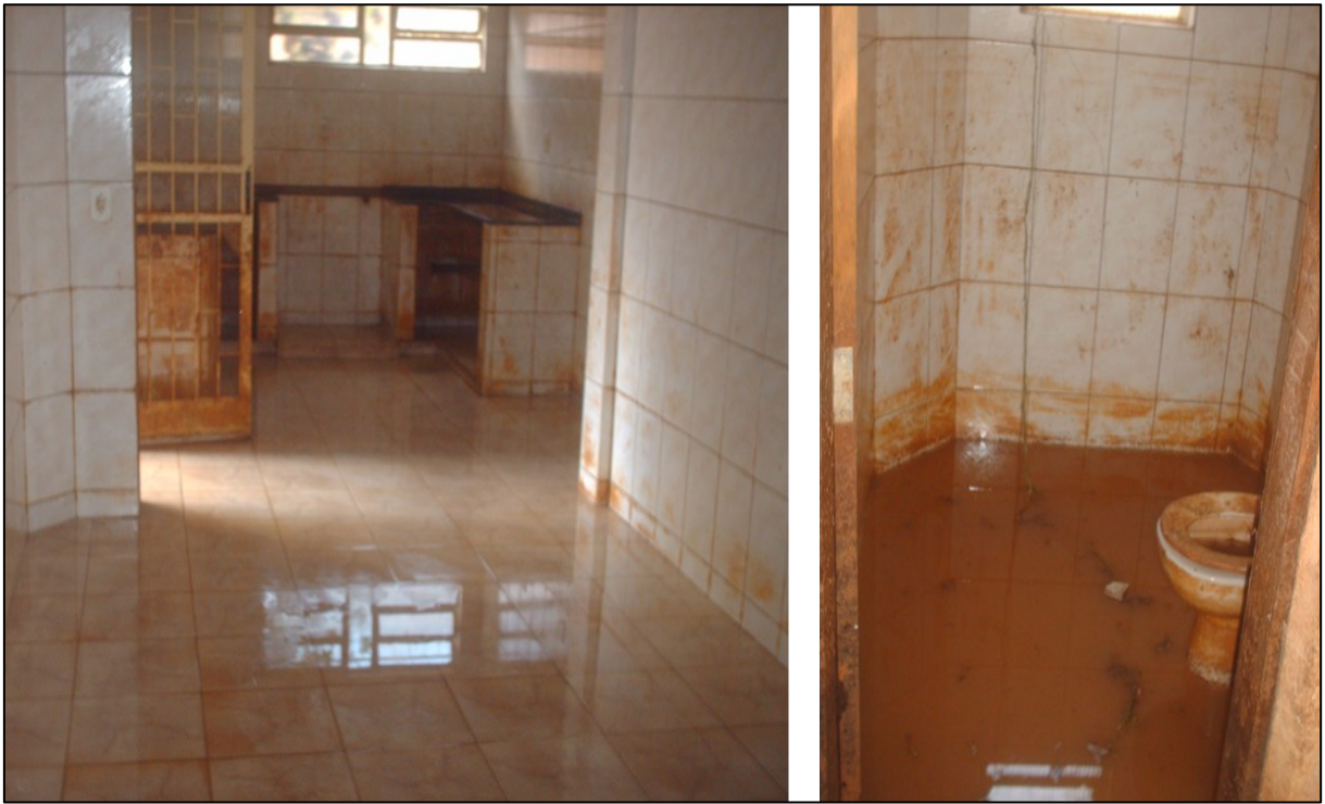
Figura 4.10 – Aspecto dos revestimentos cerâmicos e louça sanitária após inundação em 2008 – Bairro Bom Jesus, Viçosa - MG.
