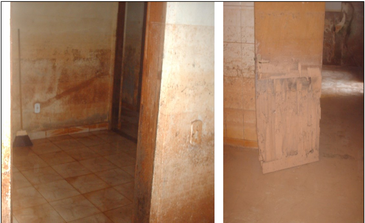
Figura 4.11 - Aspecto dos materiais de madeira e desempenho dos marcos e esquadrias após inundação em 2008 – Bairro Bom Jesus, Viçosa - MG.
