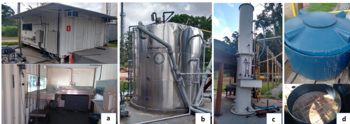
Figura 5.3 - Unidades que compõem a plataforma de metanização de resíduos alimentares e tratamento dos efluentes gerados. (a) Vista externa e interna do galpão de triagem dos resíduos; (b) Biodigestor anaeróbico de resíduo alimentar; (c) Reator UASB e (d) Vista externa e interna da unidade de separação sólido-líquido.
